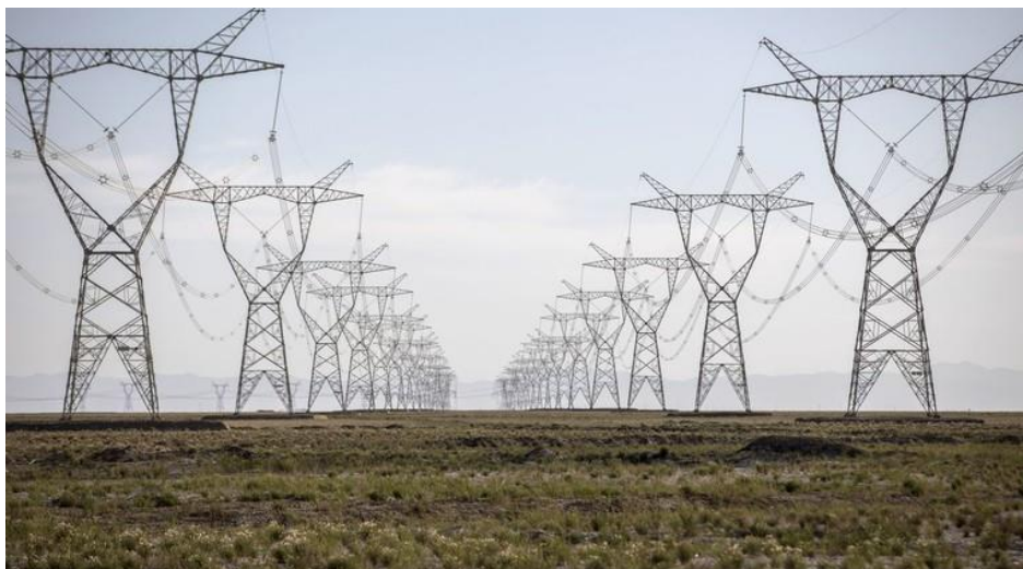
Εικόνα 8. Ηλεκτρικές γραμμές υψηλής τάσης
