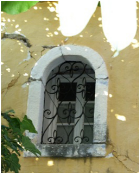
Εικόνα 95 θραύση των λαξευτών λίθων του τόξου στην περιοχή σύνδεσής του με το λαμπά σε άνοιγμα της βόρειας όψης
