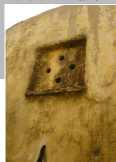
Εικόνα 90 Ρηγματώσεις και δυσχρωμία επιχρίσματος
