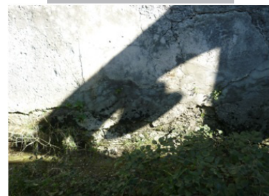
Εικόνα 87 αποσάθρωση επιχρίσματος της νότιας όψης λόγω υγρασίας θεμελίων
