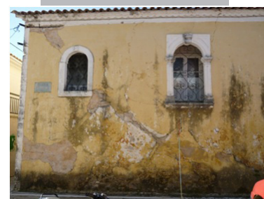
Εικόνα 88 Περιμετρική λωρίδα διαφορετικού χρώματος στη βάση του ναού λόγω απορρόφησης υγρασίας από το θεμέλιο
