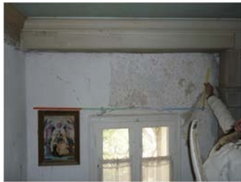
Εικόνα 99 αποκόλληση κουφώματος νότιας όψης στην περιοχή του γυναικωνίτη
