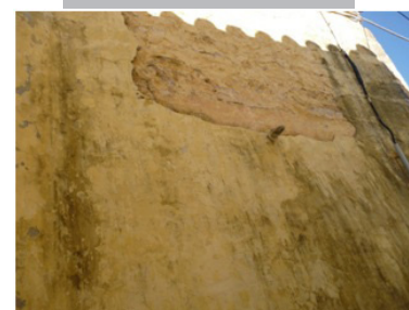
Εικόνα 89 δυσχρωμίες στο επίχρισμα, αποκόλληση τμήματος επιχρίσματος λόγω μεγάλου πάχους κονιάματος
