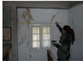
Εικόνα 100 αποκόλληση κουφώματος βόρειας όψης στην περιοχή του γυναικωνίτη
