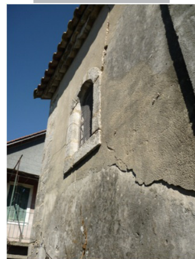
Εικόνα 102 Τσιμεντοκονιάματα στη νότια όψη – Μεταγενέστερη επέμβαση
