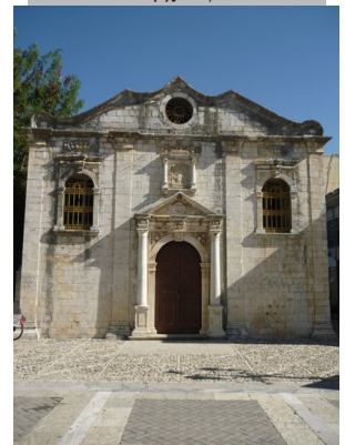
Εικόνα 10 Πρόσοψη του ΙΝ Παντοκράτορος σύγχρονη φωτογραφία. Διακρίνεται η έντονη φθορά λόγω υγρασίας
