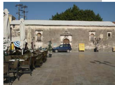
Εικόνα 3 Βόρεια Όψη ΙΝ Αγίου Σπυρίδωνα. Διακρίνονται οι διαμητικές ρωγμές κυρίως γύρω από τα ανοίγματα αλλά και η υγρασία. Οι ρωγμές διαδίδονται κυρίως μέσω των αρμών και σπάνια διαρρηγνύουν το λιθόσωμα
