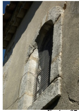
Εικόνα 97α θραύση του λαμπά σε ένα άνοιγμα της νότιας όψης
