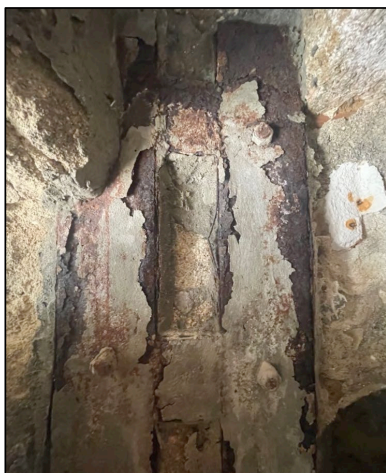
Επέμβαση ενίσχυσης με λάμες και μηχανικά βλήτρα. Σήμερα έχουν διαβρωθεί.
