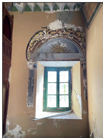
ρηγμάτωση μεταξύ τοξωτού υπέρθουρου και πτυχωτού ημιχώνιου
