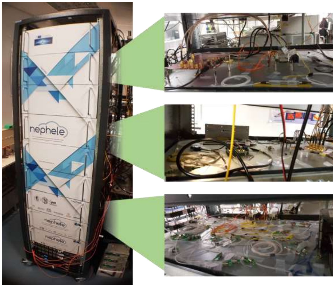
Εικόνα 105: Το ολοκληρωμένο rack του πρότυπου mini-datacenter, που περιέχει όλα τα υποσυστήματα
