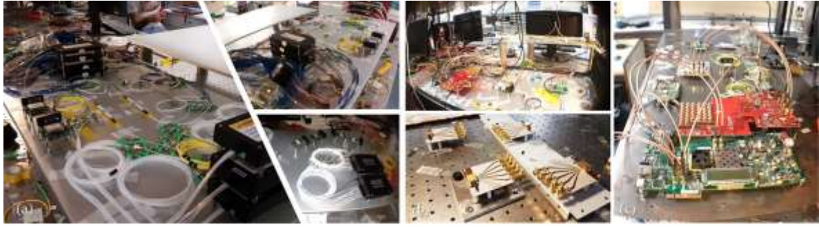
Εικόνα 11: Φωτογραφίες του μίνι datacenter κατά την περίοδο της προετοιμασίας. (α) Ο διακόπτης rod, συμπεριλαμβανομένου ενός WSS. (β) Τα γρήγορα λέιζερ που χρησιμοποιούνται για τον πομπό. (γ) Τα FPGA extenders του ToR διακόπτη
