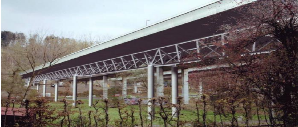
Σχήμα 2-17: The Lully Viaduct bridge, παράδειγμα εφαρμογής χωρικού δικτυώματος σε ανωδομή γέφυρας μόνιμης δομής,
