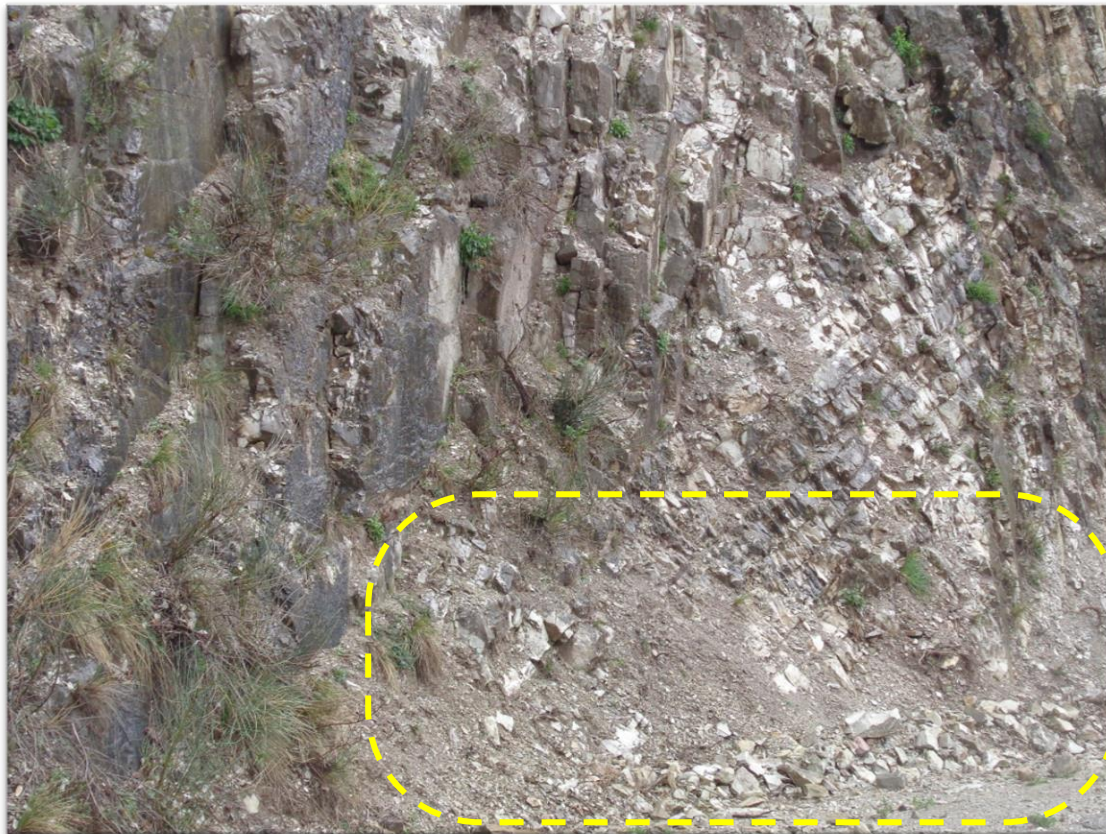
Εικόνα 5-4: Τμήμα του πρανούς όπου η βραχώμαζα επιφανειακά είναι κατακερματισμένη στο ύψος του υφιστάμενου οδικού δικτύου
