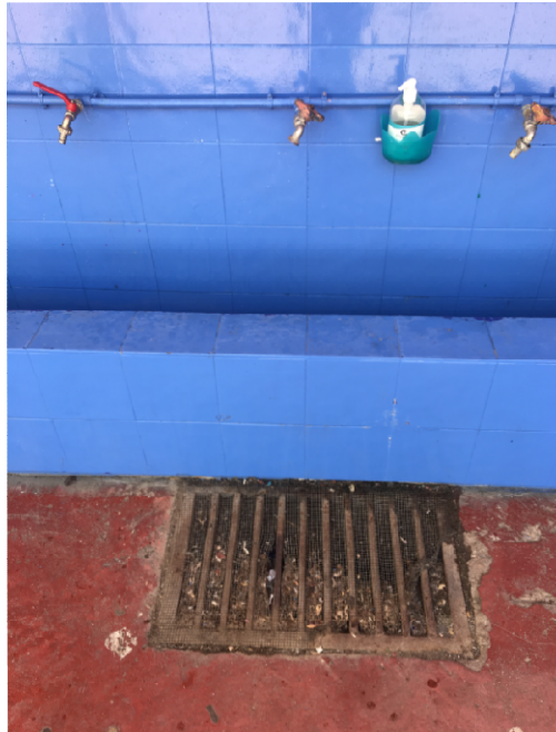
Εικόνα 30 Φρεάτιο αποχέτευσης εντός του σχολείου
