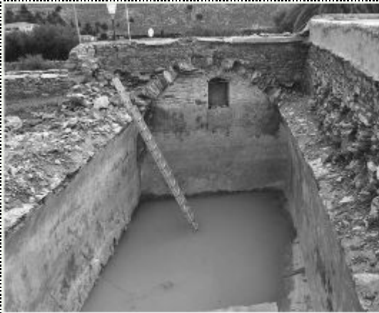
Η δεξαμενή νερού μετά την κατάρρευση της οροφής της
