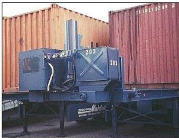
Σχήμα 2.1.19: Πλαίσιο με εξοπλισμό εκκένωσης του εμπορευματοκιβωτίου στο άκρο του
