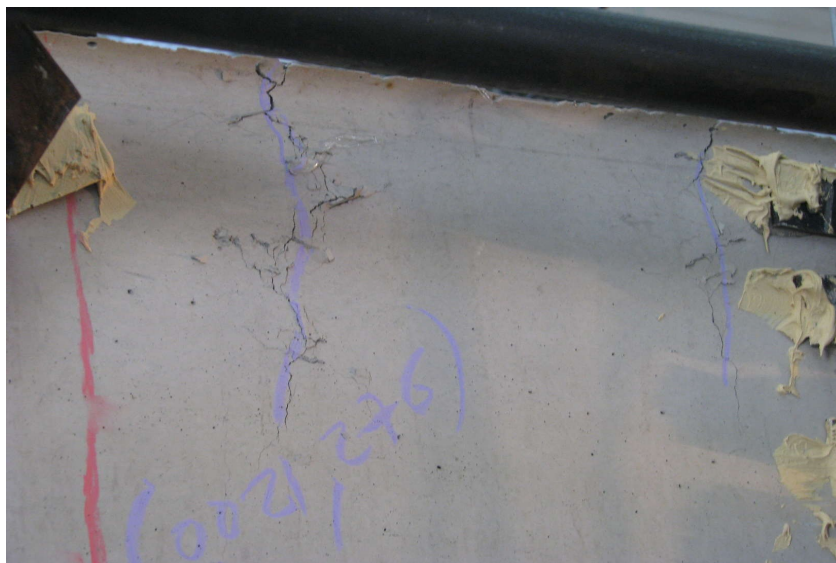
Εικόνα 5.2.1.4: Εμφάνιση καμπτικών ρωγμών στην περιοχή σταθερής ροπής
