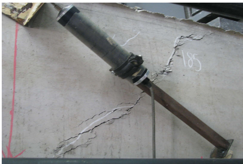
Εικόνα 5.6.1.3: Επέκταση δεξιά διατμητικής ρωγμής σε χαμηλή στάθμη φορτίου
