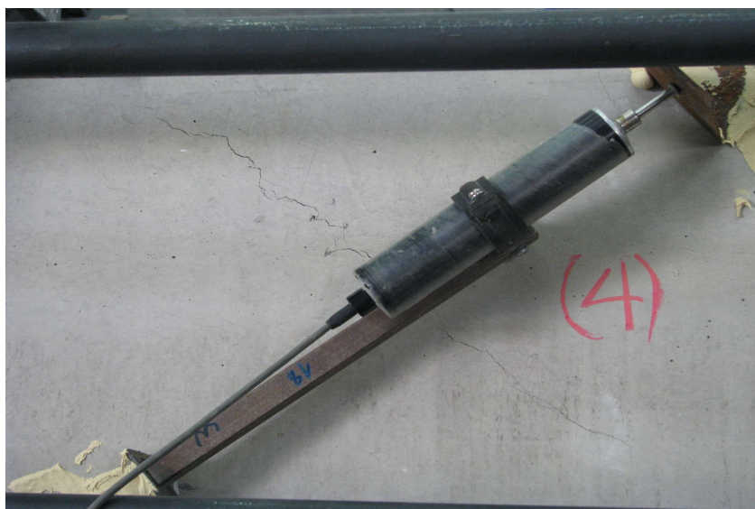
Εικόνα 5.3.1.3: Επέκταση αριστερά διατμητικής ρωγμής σε χαμηλή στάθμη φορτίου
