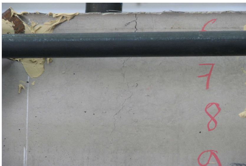
Εικόνα 5.3.1.6: Εμφάνιση καμπτικής ρωγμής στην περιοχή σταθερής ροπής
