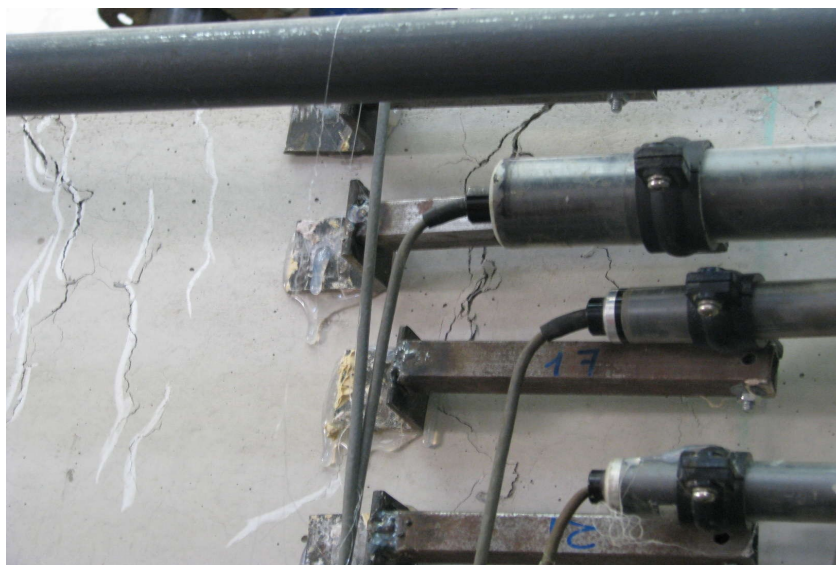
Εικόνα 5.5.1.4: Επέκταση καμπτικών ρωγμών
