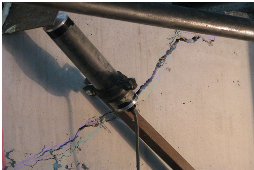
Εικόνα 5.2.1.3: Επέκταση διατμητικής ρωγμής στη δεξιά πλευρά του δοκιμίου
