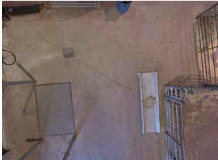
Εικόνα 3.2 Ρωγμή στην επιφάνεια σκυροδέματος, λήψη από drone (Seo et al, 2018)
