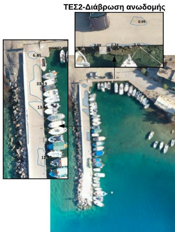
Εικόνα 6.12 Διάβρωση ανωδομής στο αλιευτικό καταφύγιο Αλυκής (ΤΕΣ2)
