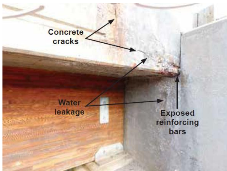
Εικόνα 3.3 Φθορές σε βάθρο σύμμικτης γέφυρας (Seo et al, 2018)
