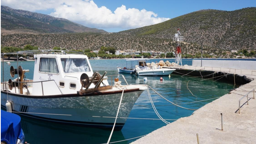
Εικόνα 6.4 Αποκόλληση κατά μήκος των δεσμών στο αλιευτικό καταφυγίου Παραλίας Σαράντη
