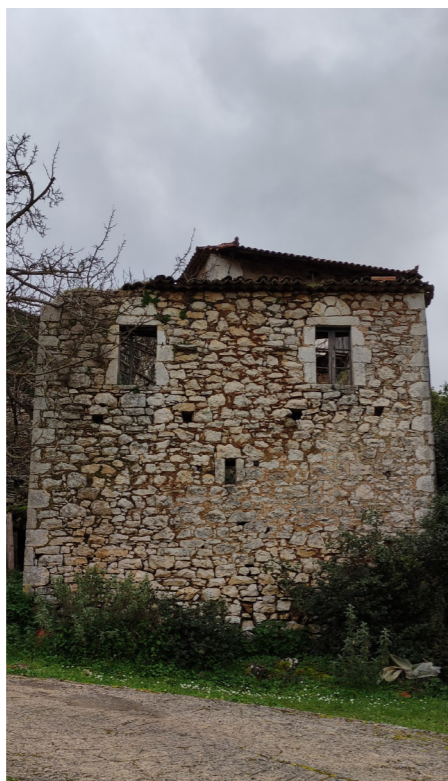
Εικ.13 Μη αποκατεστημένη κατοικία
