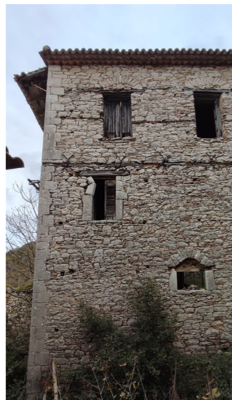
Εικ.14 Μη αποκατεστημένη κατοικία
