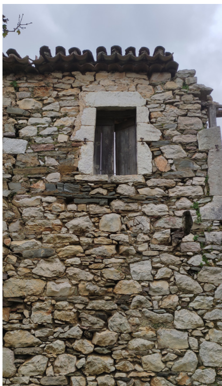
Εικ.12 Μη αποκατεστημένη κατοικία
