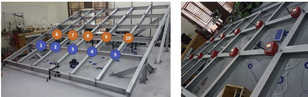
Σχήμα 5.15. Χαλύβδινη κατασκευή (αριστερά) και διάταξη ασύρματων αισθητήρων επί αυτής (δεξιά) [ Anci et al. , 2018]
