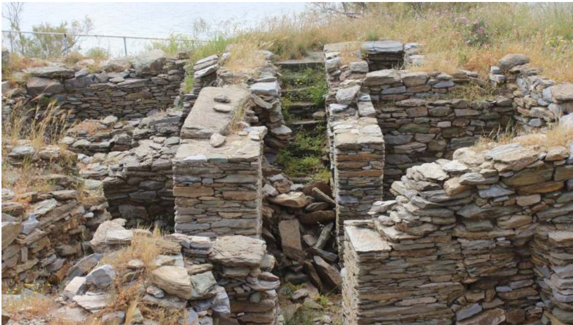
Εικόνα 2.8 : Τμήμα της οικίας Α με έντονες καταρρεύσεις .
