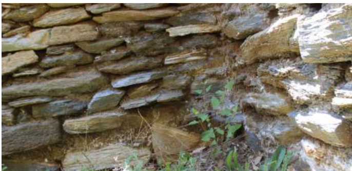
Εικόνες 2.45 - 2.47 : Τμήματα τοιχοποιίας που παρουσιάζουν διάβρωση ή θραύση λίθων.
