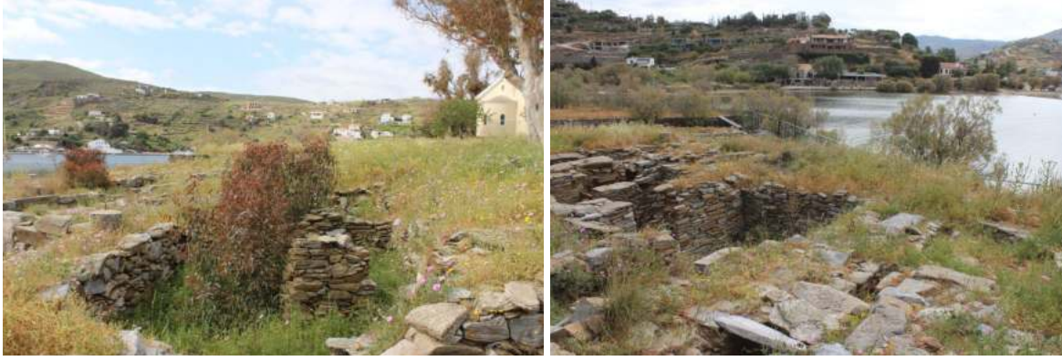
Εικόνα 2.13 : Ευκάλυπτος αναπτύσσεται πάνω σε τοιχοποιία. Εικόνα 2.14 : Έντονη βλάστηση στην Οικία Α.
