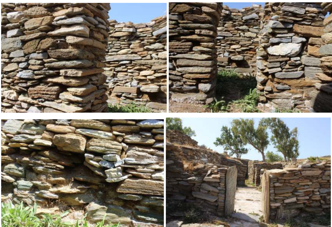
Εικόνες 2.32 - 2.33 : Απώλεια κονιάματος στον διαχωριστικό τοίχο μεταξύ των δωματίων 1 και 2.
