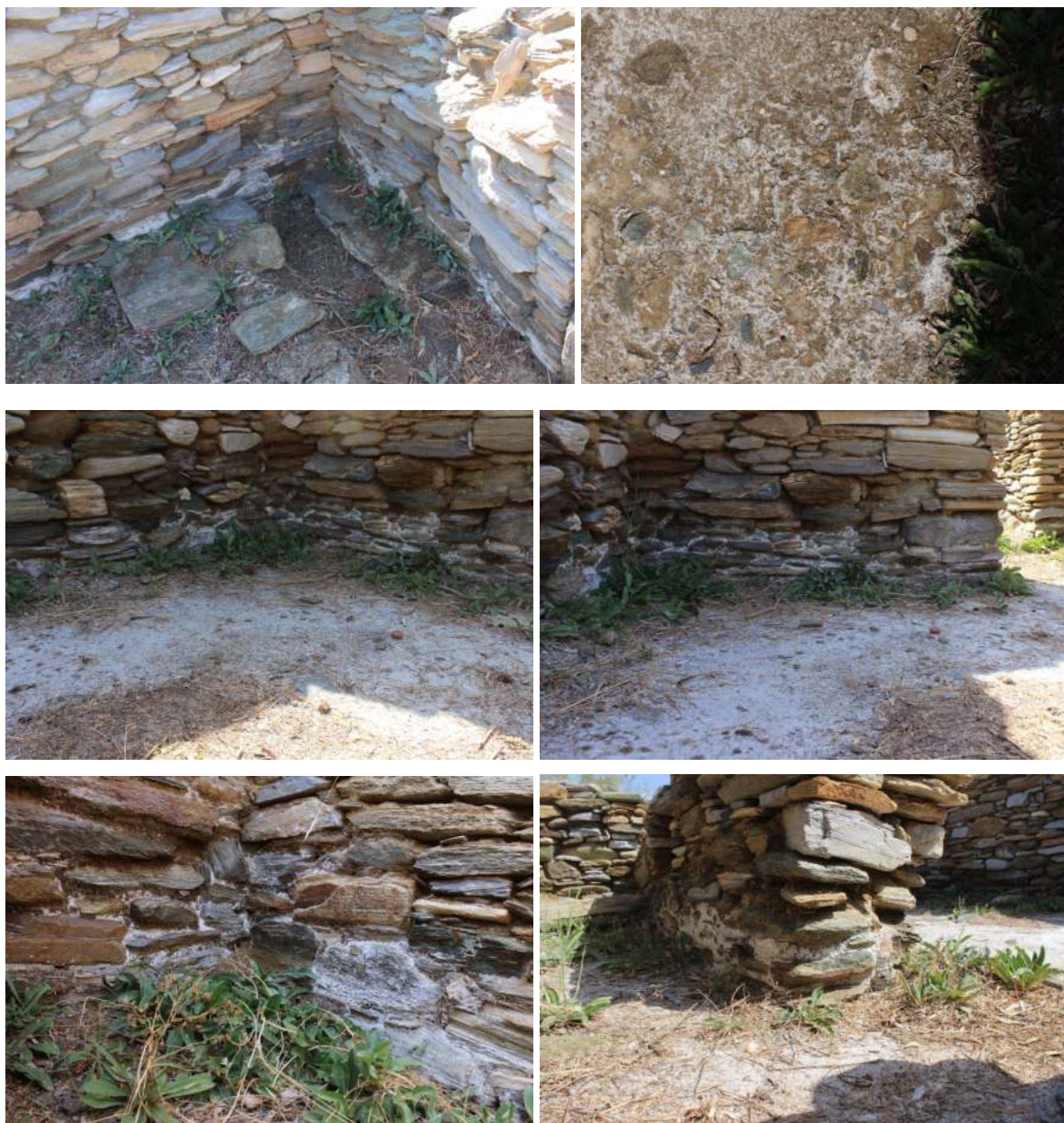
Εικόνες 2.39 - 2.40 : Επικαθίσεις αλάτων στο δωμάτιο 6.
