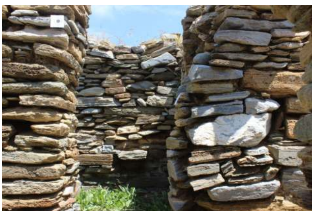
Εικόνα 2.36 : Φουσκώματα τοιχοποιίας στο δωμάτιο 2.
