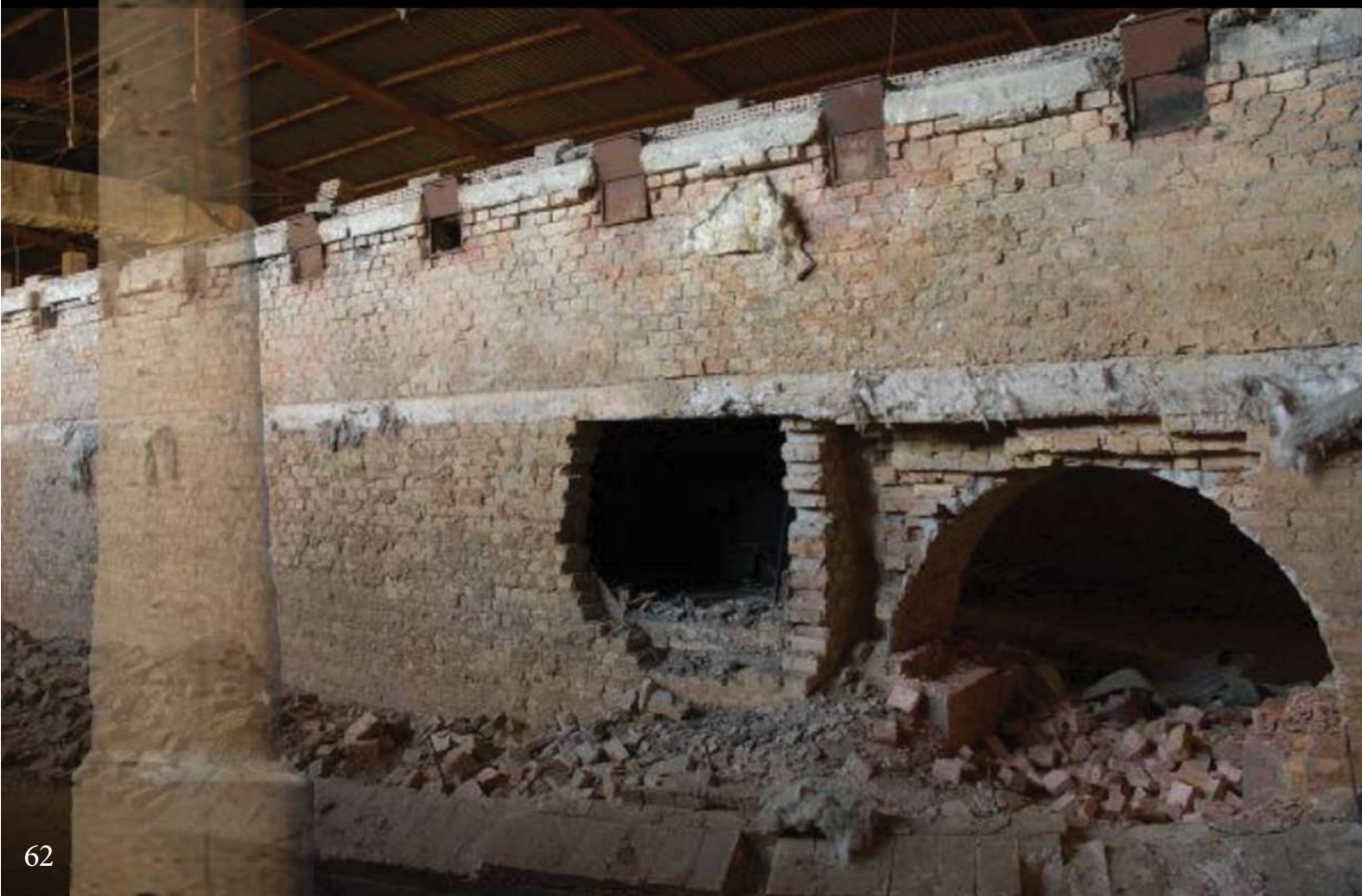
Εικόνα 2.58 | Φούρνος όπτησης πλίνθων τύπου Tunnel Modulo
