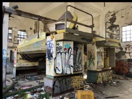
Εικόνα 2.100 | Μηχανολογικός εξοπλισμός Οινοποιείου
