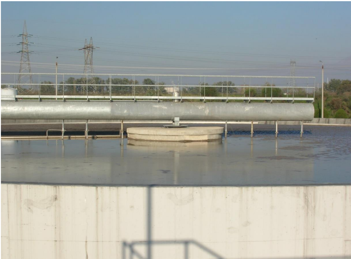
Εικόνα 4 - Δεξαμενή δευτεροβάθμιας καθίζησης [44] .
