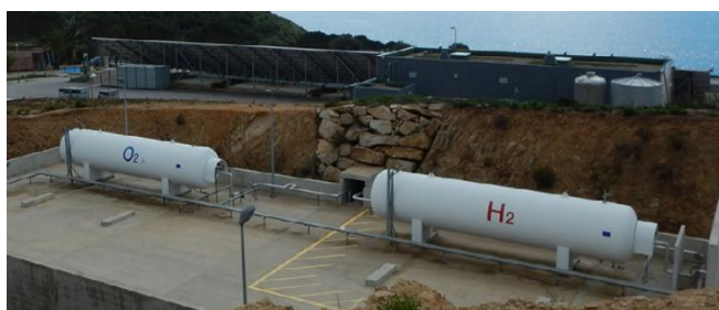
Εικόνα 2. Δεξαμενές υδρογόνου και οξυγόνου σε αποκεντροποιημένη μονάδα ηλεκτρόλυσης.
