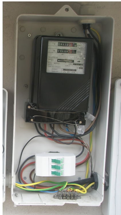
Σχήμα 1.2: Φωτογραφία από ένα ανοιγμένο πίνακα εισαγωγής.
