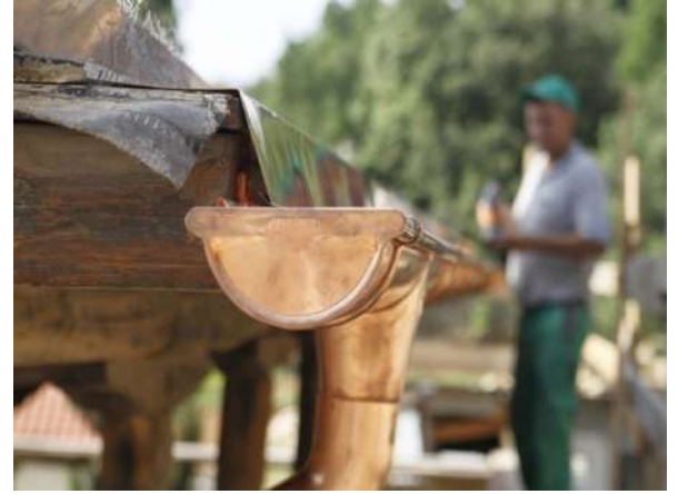
Πρόταση αντικατάστασης υδρορορών με νέες χάλκινες
