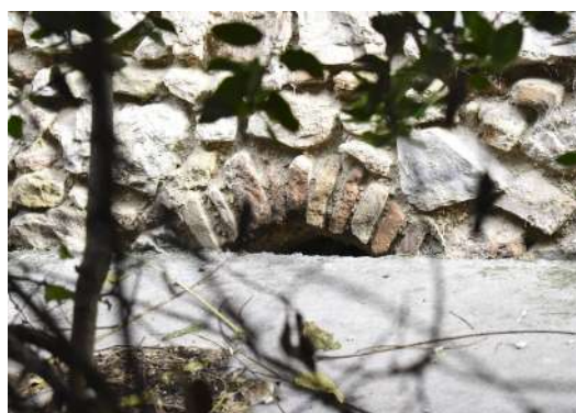
Τόξο κάτω από τον εξώστη οπλισμένου σκυροδέματος σε κατακόρυφο άξονα του αποχετευτικού αγωγού στη δυτική όψη (βλ. δυτική όψη)
