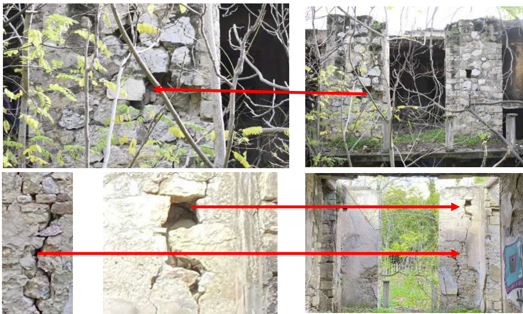
Ρωγμή εύρους 25 εκ. στη βόρεια όψη. Πάνω στην εξωτερική και κάτω στην εσωτερική παρειά του τοίχου
