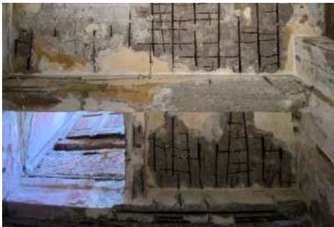
Ταβάνι χώρου 2.16 και 2.17 χώρος φωταγωγού- εμφάνιση οπλισμών
