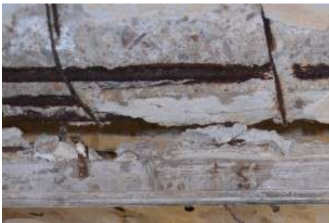
Δοκός μεταξύ χώρου 2.15 και 2.16 χώρος φωταγωγού -χαμηλή ποιότητα σκυροδέματος
