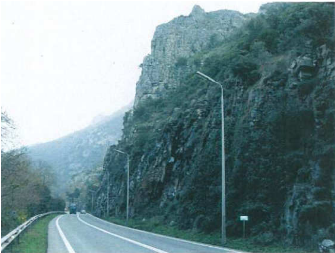
Εικόνα 7.2. Άποψη του πρανούς στην Χ.Θ. 387+130.
