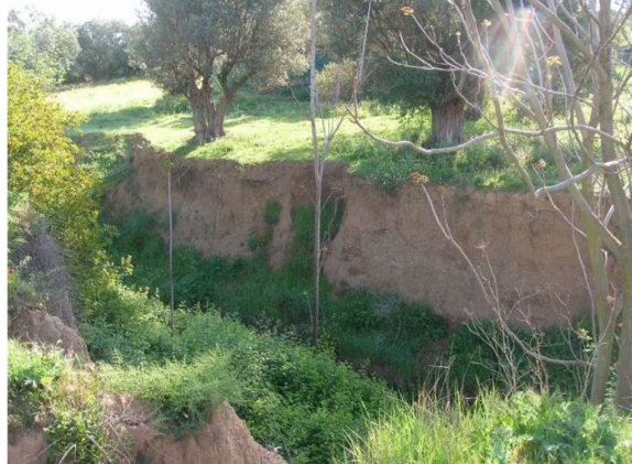
Εικόνα 3.3-6: Λήψη από τη δεξιά όχθη προς τα ανάντη, Χ.Θ. 3+240. Διακρίνονται ελαιόδεντρα στη δεξιά όχθη
