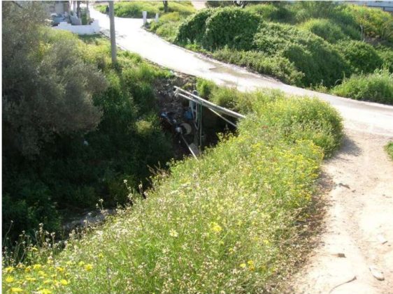
Εικόνα 3.3-5: Τεχνικό Αγ. Φανουρίου, Χ.Θ. 3+745.30, λήψη από την ανάντη δεξιά όχθη. Σωλήνες ΟΚΩ είναι αναρτημένοι από τον οχετό.
