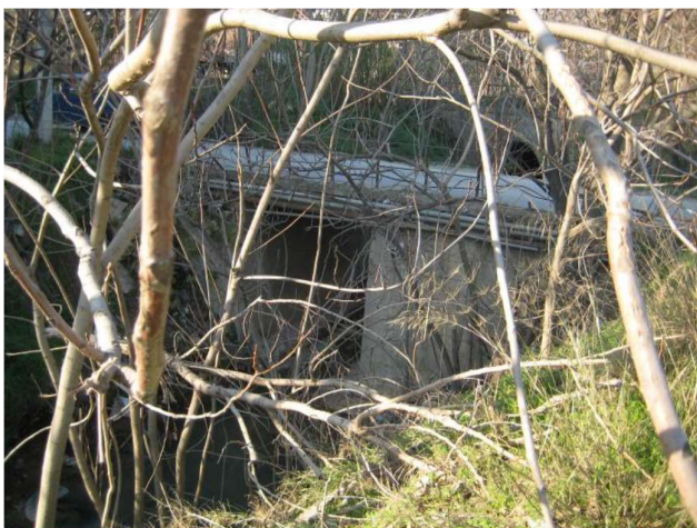
Εικόνα 3.3-4: Τεχνικό Σπ. Βρεττού, Χ.Θ. 4+135.20, λήψη από την αριστερή κατάντη όχθη. Διακρίνονται σωλήνες δικτύων ΟΚΩ αναρτημένοι από την κορωνίδα.
