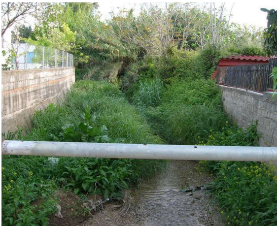
Εικόνα 3.3-9: Μάντρες κτισμάτων στην κοίτη, αμέσως ανάντη της οδού Παλαιολόγου.
