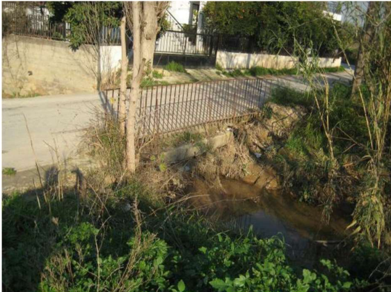
Εικόνα 3.3-7: Τεχνικό οδού Παλαιολόγου, λήψη από την αριστερή κατάντη όχθη προς τα ανάντη.
