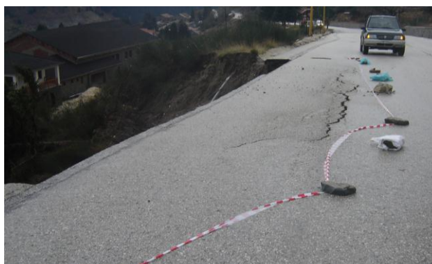
Εικόνα 3.23: Ρωγμές στο οδόστρωμα του Εθνικού δρόμου Ιωαννίνων-Τρικάλων. Απαιτούνται συρματοκιβώτια κατάντη του δρόμου για τη συγκράτησή του.
