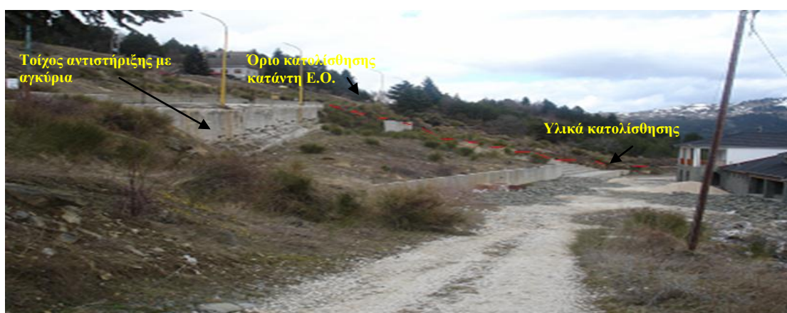
Εικόνα 3.22: Τοίχος αντιστήριξης με αγκύρια ανάντη του παγοδρομίου και κατάντη του Εθνικού δρόμου.
