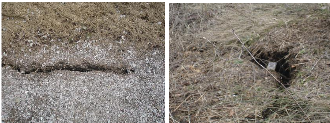
Εικόνα 3.24: Αποψη ανοιχτών ρωγμών παράλληλες προς το οδόστρωμα, βορειότερα από τη θέση κατολίσθησης.
