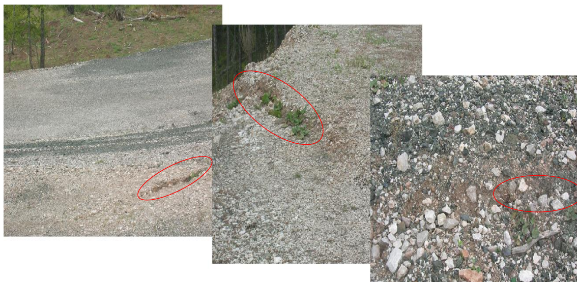
Εικόνα 4.33: Ρωγμές που παρατηρήθηκαν στο αντίβαρο, τον Οκτώβριο του 2010.
