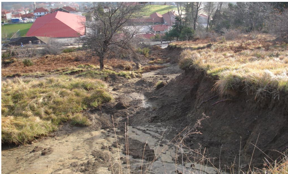
Εικόνα 3.25: Άποψη της κατολίσθησης ανάντη του εθνικού δρόμου Ιωαννίνων-Τρικάλων.
