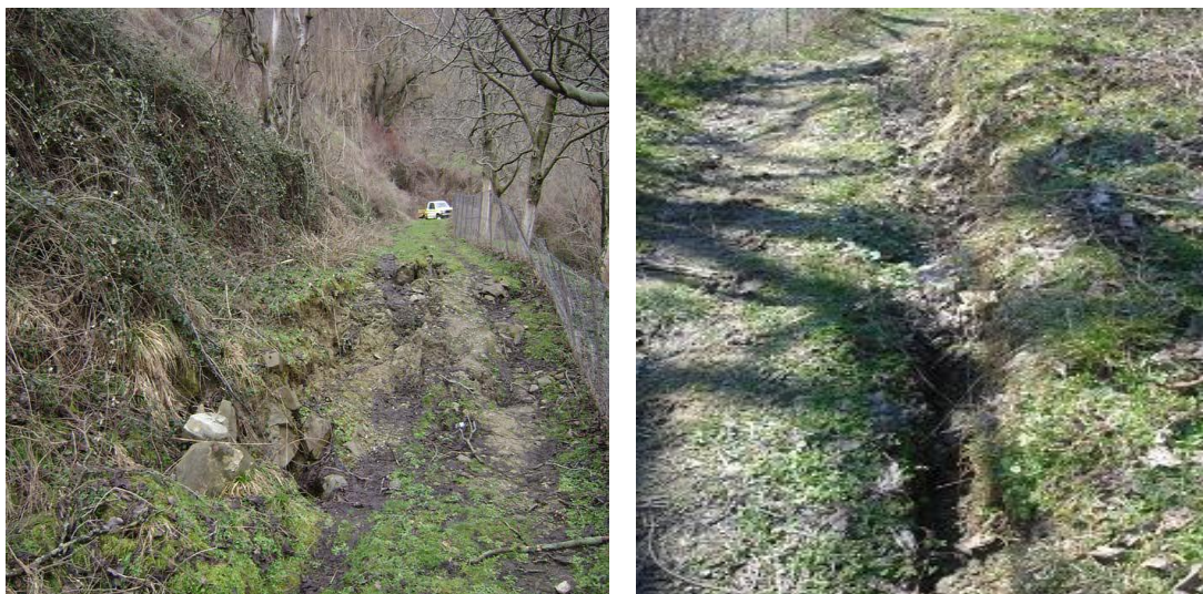
Εικόνα 3.12: Αστοχίες στο αδόμητο πρανές, σε εδαφικά υλικά, στον αγροτικό δρόμο προς Ι.Μ. Παναγίας κατάντη της κατολίσθησης.
