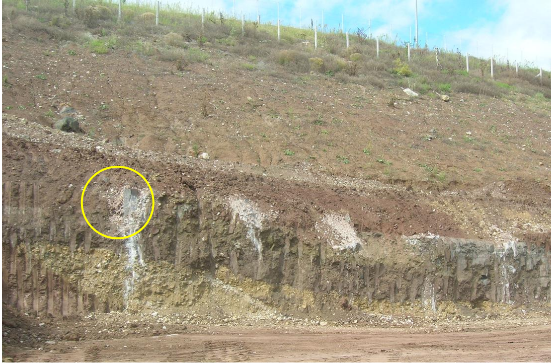
Εικόνα 4.30: Άποψη του σταθεροποιητικού επιχώματος κατάντη του αυτοκινητόδρομου και κατασκευή φρεατοπασσάλων για την ενίσχυση της ευστάθειας της κατολίθησης.
