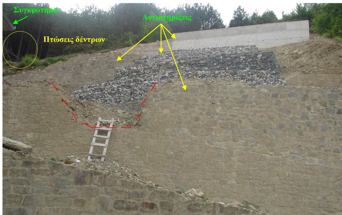
Εικόνα 3.20: Συνδυασμένη άποψη τοίχων αντιστήριξης και συρματοκιβωτίων για την ενίσχυση του πόδα της κατολίσθησης και του πρανού. Παρατηρείται θραύση στον τοίχο αντιστήριξης, εξαιτίας των μετακινήσεων που εκδηλώθηκαν το 2010, καθώς και πτώσεις δέντρων.
