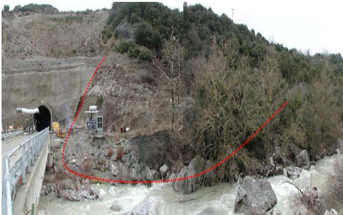
Εικόνα 4.7: Περιοχή κατασκευής του πόδα του οπλισμένου επιχώματος, στο τμήμα 2.4 της Εγνατίας Οδού, στην περιοχή Β (υποπεριοχή Β1). Τα υπάρχοντα έργα της ΔΕΗ και η παρουσία του ποταμού, περιορίζουν την κατασκευή του επιχώματος σε αυτή τη θέση.
