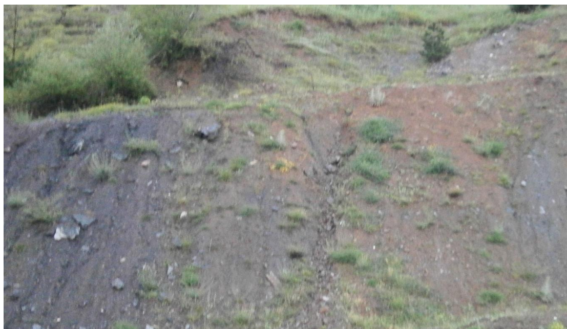
Εικόνα 4.24: Διαβρώσεις και μετακινήσεις στο φρύδι του πρανούς.
