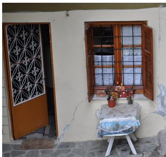
Εικόνα 3.10: Ρωγμές στην τοιχοποιία της οικίας κ. Πυξομάτη.
