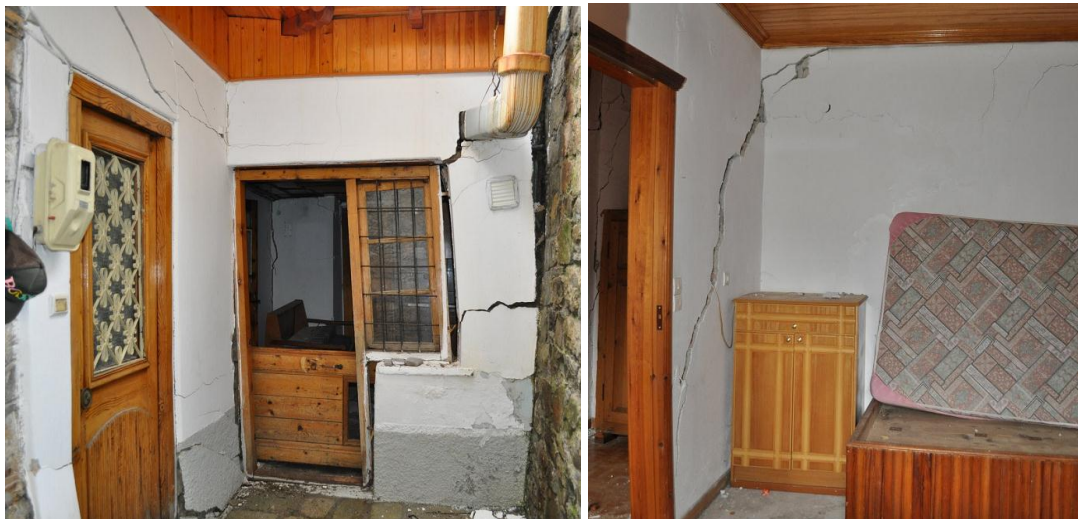
Εικόνα 3.9: Ρωγμές, σπασίματα που έχουν προκληθεί στην τοιχοποιία της οικίας του κ. Σ. Μπάου.
