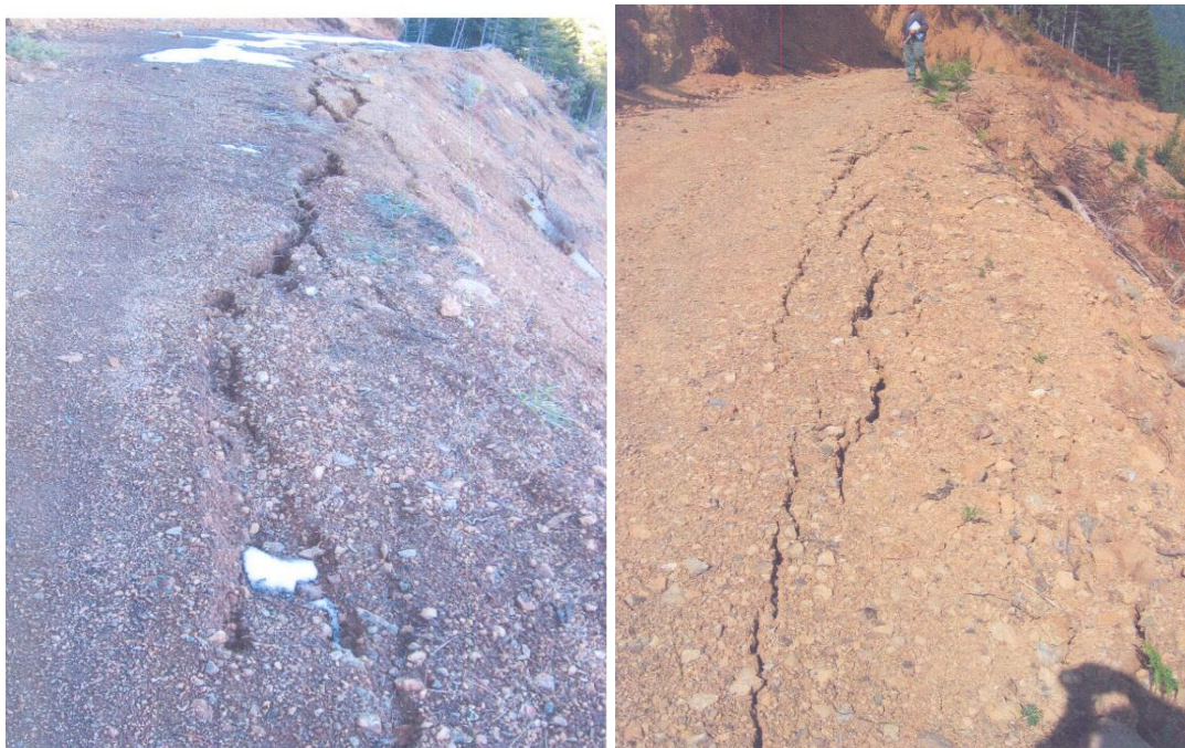
Εικόνα 4.18: Ανοιχτές εφελκυστικές ρωγμές και επιμήκεις θραύσεις μεγάλου μήκους, στις τεχνητές επιχώσεις, κατά μήκος του χείλους του ορύγματος.
