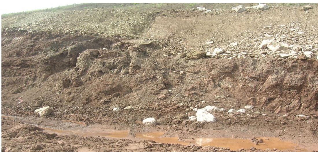
Εικόνα 4.29: Άποψη επιχώματος κατάντη του δεξιού κλάδου. Διακρίνονται θραύσεις, διαβρώσεις, στη βάση του επιχώματος, εξαιτίας του νερού που έχει εγκλωβιστεί στα αργιλικά υλικά.
