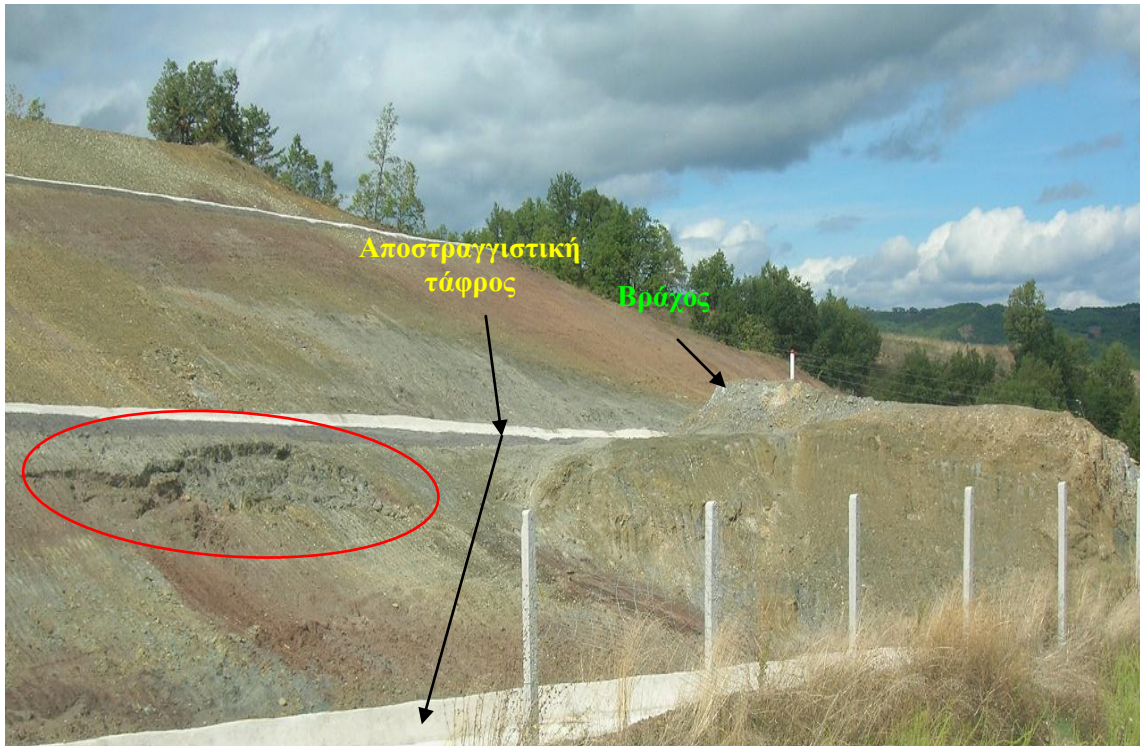
Εικόνα 4.24: Άποψη χαμηλού επιχώματος Ε6 αριστερά του αριστερού κλάδου της Ε.Ο. Σημειώνονται ο βράχος (όριο μεταξύ υψηλού και χαμηλού επιχώματος) που λειτουργεί σταθεροποιητικά στο επίχωμα και οι ρωγμές-σπασίματα που έχουν προκληθεί στο επίχωμα.
