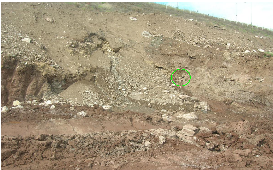
Εικόνα 4.25: Άποψη υψηλού επιχώματος Ε6 κατάντη του δεξιού κλάδου της Ε.Ο. Παρατηρούνται αστοχίες στο σώμα του επιχώματος, αγωγός εκτόνωσης του νερού από το επίχωμα και έντονη υγρασία.
