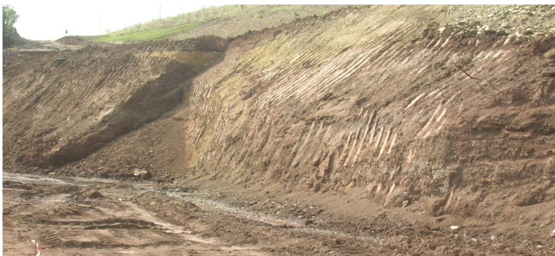
Εικόνα 4.28: Άποψη του επιχώματος κατάντη του δεξιού κλάδου του αυτοκινητόδρομου, όπου παρατηρείται αστοχία.
