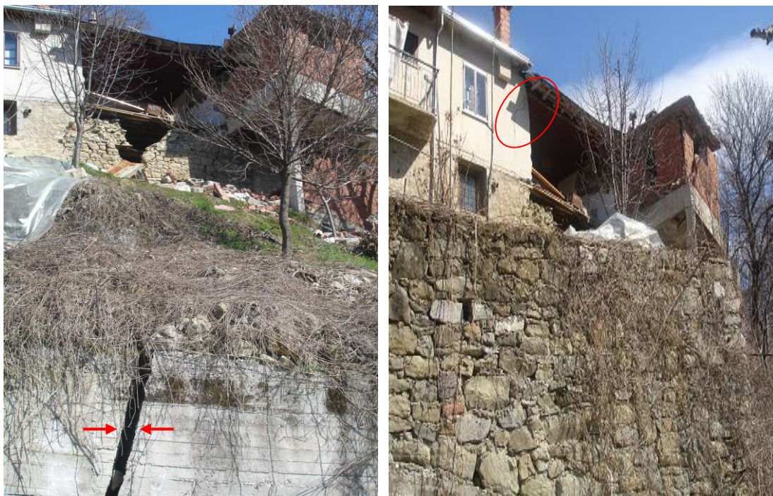
Εικόνα 3.14: Ρωγμές, σπασίματα στην οικία Πάφη, στους τοίχους αντιστήριξης, καθώς και ρωγή στην τοιχοποιία του διπλανού σπιτιού. Στις ανοιχτές ρωγμές του τοίχου αντιστήριξης από μπετόν, δεν παρατηρήθηκε επαρκής σιδηρός οπλισμός. Οι οπές του τοίχου αντιστήριξης από λιθοδομή πρέπει να καθαριστούν για καλύτερη αποστράγγιση.
