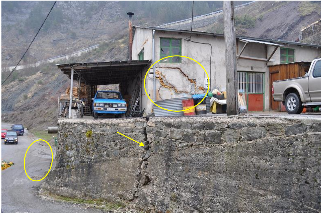
Εικόνα 3.30: Ξυλουργικό εργοστάσιο κ. Αγγέλη. Παρατηρούνται ρωγμές στο οδόστρωμα, στην τοιχοποιία και στο κτήριο.
