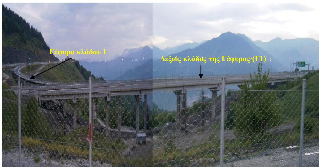
Εικόνα 4.23: Άποψη της γέφυρας (Γ1) των δύο ανεξάρτητων κλάδων και της γέφυρας κλάδου εξόδου, με κατεύθυνση προς την Παναγία.
