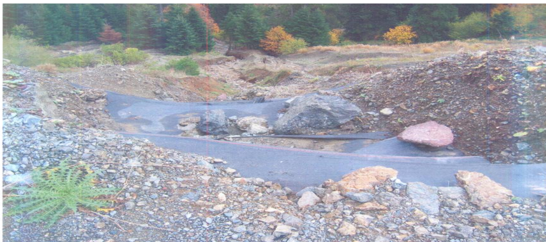
Εικόνα 4.20: Βελτίωση του χείλους των τεχνητών επιχώσεων κατά μήκος του μεγάλου ορύγματος με χρήση γεώπανων. Κατόντη διακρίνονται οι έντονες διαβρώσεις και η φυτοκαλυμμένη περιοχή.
