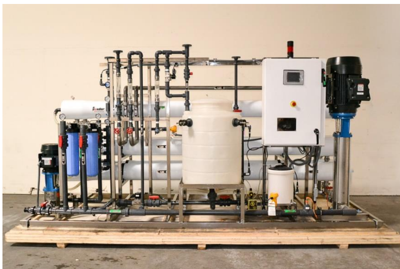
Σχήμα 5.20: Σύστημα Premium NF πλήρως αυτοματοποιημένο με σήματα οργάνων που ρυθμίζουν τη λειτουργία και τη δοσολογία του συστήματος, καθώς και μια ανεξάρτητη αντλία CIP και ανακυκλοφορία για πειραματική χρήση.
