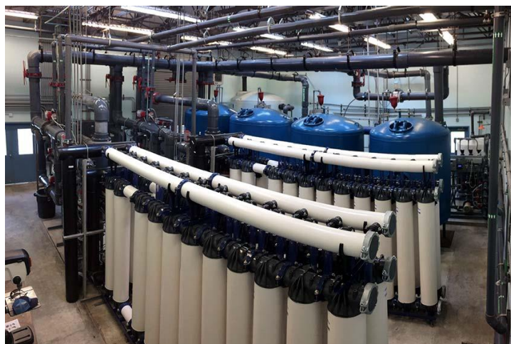
Σχήμα 5.18: Συστήματα κλινών με μεμβράνες υπερδιήθησης σε εγκαταστάσεις επεξεργασίας νερού
