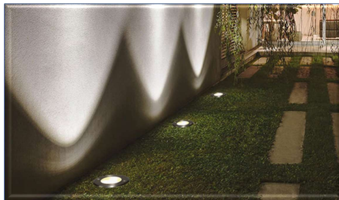
Εικόνα 29: Εξωτερικό φωτισμός κτηρίου με την χρήση φωτιστικών εντός δαπέδου [35].
