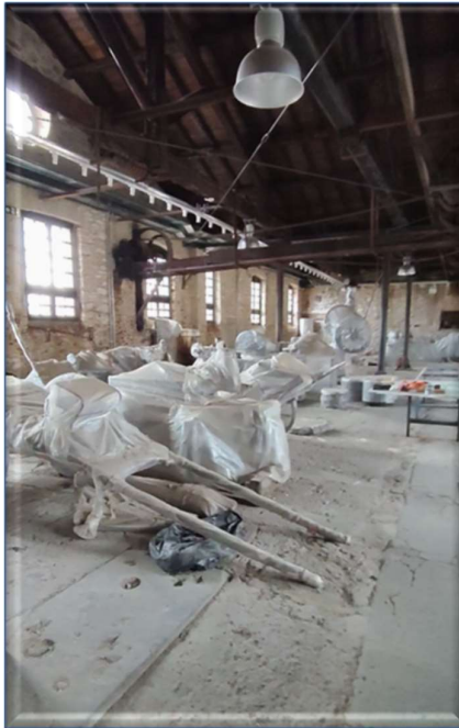
Εικόνα 57: Εσωτερική άποψη μηχανουργείου από την επίσκεψη μας, διακρίνεται η σύνδεση του άξονα με τον κινητήρα.
