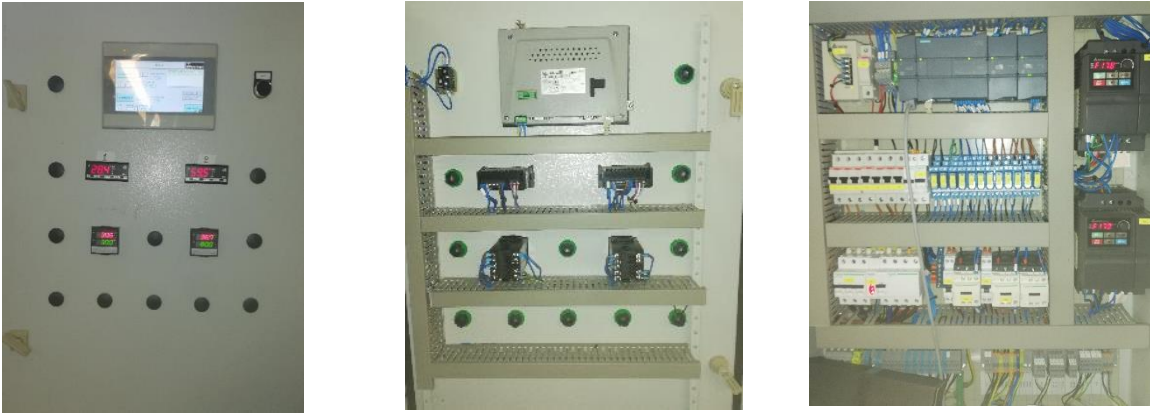
Εικόνα 18: Πίνακας ελέγχου πιλοτικής μονάδας.
