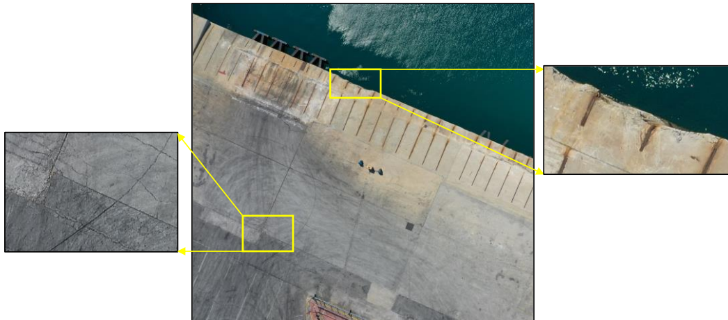
Εικόνα 3.5 Αποτύπωση της ρηγμάτωσης (αριστερά) και της φθοράς από πιθανή κρούση στην αποβάθρα του τομέα ακτοπλοΐας του λιμένα Λαυρίου, όπως αποτυπώθηκε κατά την επιτόπια επισκόπηση της ομάδας του ΕΛΕ, ΕΜΠ με πτήση ΣμηΕΑ.
