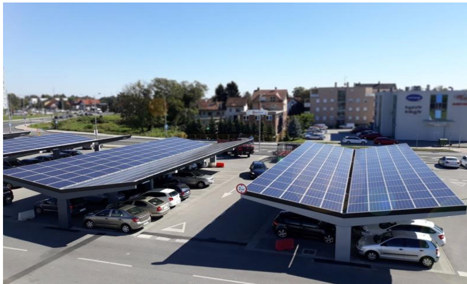
Εικόνα 3–6 Παράδειγμα εφαρμογής φωτοβολταϊκών συστημάτων σε χώρους στάθμευσης ΙΧ («parking lot PV canopy installations»).
