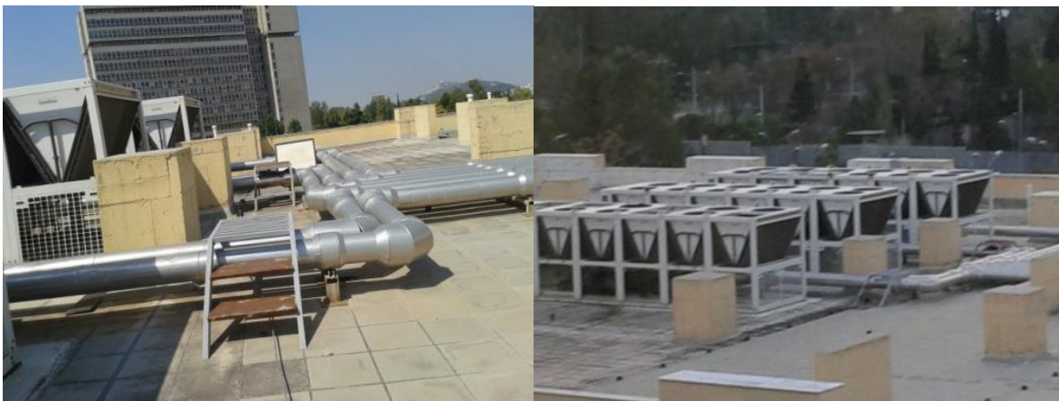
Εικόνα 3–4 Τρεις συστοιχίες παραγωγής ψυχρού νερού στην οροφή του 401 ΓΣΝΑ.
