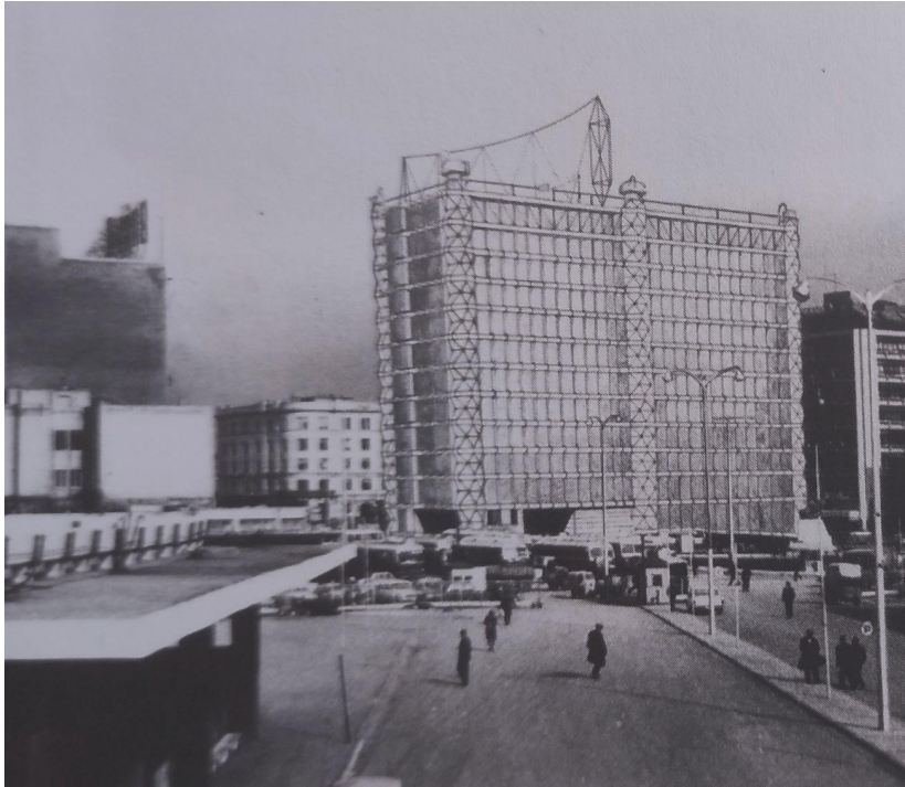
Εικόνα: Κτίριο γραφείων ΟΛΠ στον Πειραιά, συμμετοχή σε πανελλήνιο αρχ.διαγωνισμό, 1970,Καλογεράς σε συνεργασία με τους Πάνο Κουλέρμο και Σπύρο Αμούργη, πηγή: (Τσακόπουλος, 2014, σ. 320)
