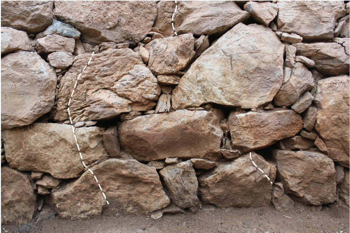
Απώλεια κονιάματος και θραυσμένοι λίθοι.
