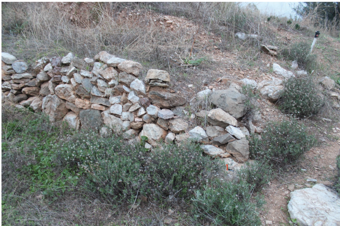
Άποψη της νοτιοανατολικής τοιχοποιίας του δρόμου (πάνω: κατά την ανασκαφή, πηγή: αρχείο κας Κονσολάκη, κάτω: υφιστάμενη κατάσταση).
