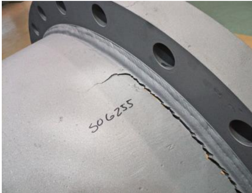
Σχήμα 28. Ρωγμή σε συγκόλληση κυλινδρικού αγωγού. [26]
