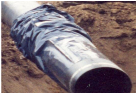
Εικ.2.17: Προστασία σωλήνων από τη διάβρωση με ταινίες πίσσας.
