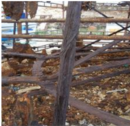
Εικ 3.16. Συνδετικός άξονας με εμφανή διάβρωση.
