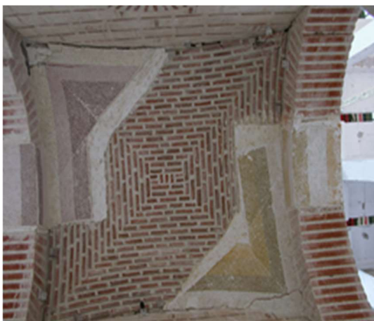
Σχήμα 2.23. Ρωγμές στο σταυροθόλιο εσωτερικά
