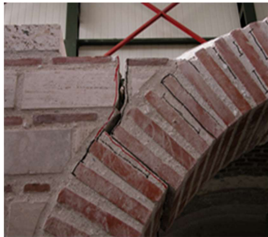
Σχήμα 2.22. Αποκόλληση σταυροθολίου στη βόρεια όψη
