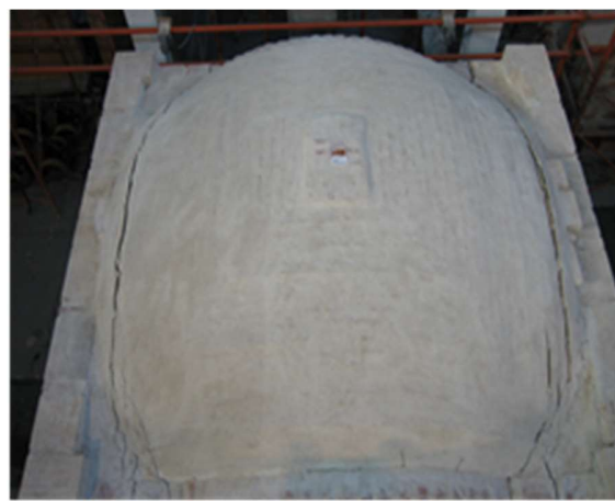
Σχήμα 2.24. Ρωγμές στο σταυροθόλιο εσωτερικά εξωτερικά
