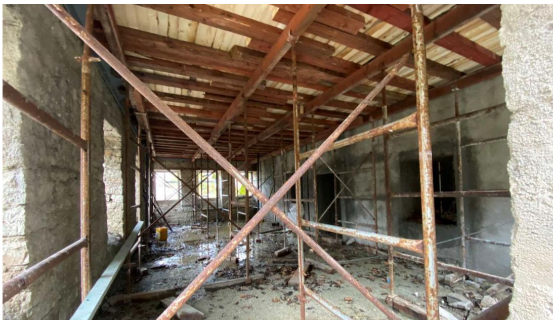
Εικ.43. Εικόνα από τις επεμβάσεις στις τοιχοποιίες του σχολείου του Διλόφου με εκτοξευόμενο σκυρόδεμα, που αποτελεί ακατάλληλη μέθοδο για τη στερέωση παραδοσιακών λιθοδομών, καθώς μπορεί να προκαλέσει περεταίρω φθορές από τη συγκράτηση υγρασίας στο εσωτερικό της τοιχοποιίας, και υποβαθμίζει το αυθεντικό δομικό σύστημα του κτίσματος. Πηγή: αρχείο Μ.Μπαλοδήμου
