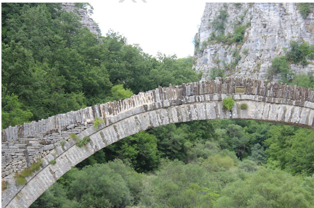
Εικ.44. Συμπλήρωση λίθων στο γεφύρι του Κόκκορη με νέο κονίαμα, ασύμβατο με το αυθεντικό.
