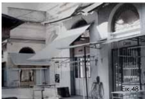
Εικ. 48: Άποψη του εσωτερικού της Δημοτικής Αγοράς Άργους πριν την αποκατάσταση του κτιρίου. Διαμόρφωση πρόχειρων στεγαστρών. Πηγή: Δωροβίνης Β., «Η δημοτική νεοκλασική αγορά του Άργους (1889-1989)», σ. 87.
