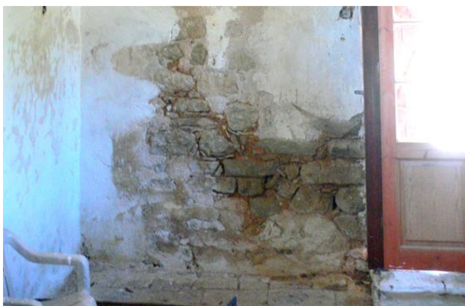
Εικόνα 142 - Αποκόλληση εσωτερικού επιχρίσματος στο εσωτερικό του Καθολικού με αποκάλυψη της υποκείμενης λιθοδομής
