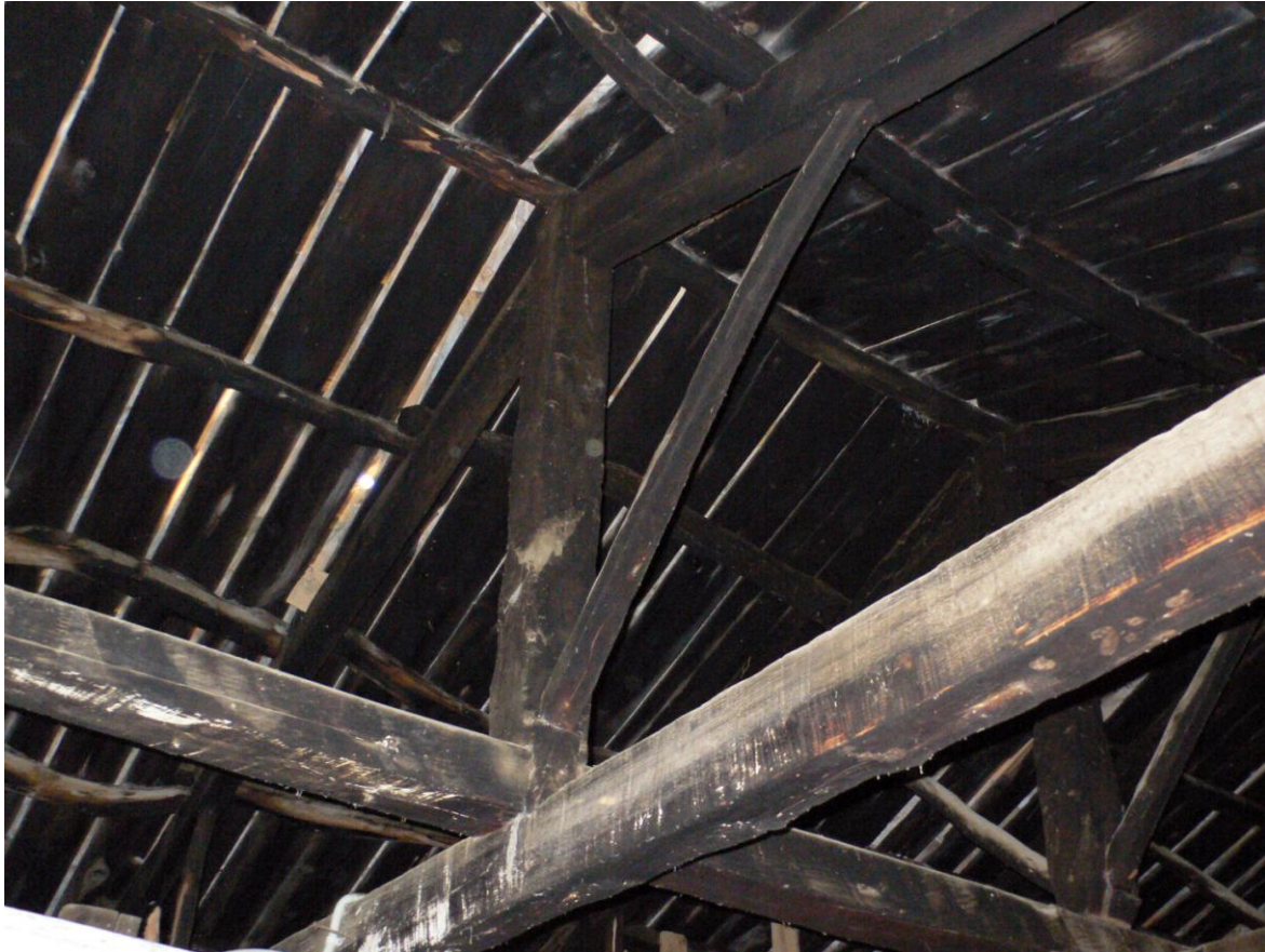
Εικόνα 27 - Ξύλινη στέγη σε εγκαταλειμμένο σπίτι στο χωριό Αλέξανδρος
