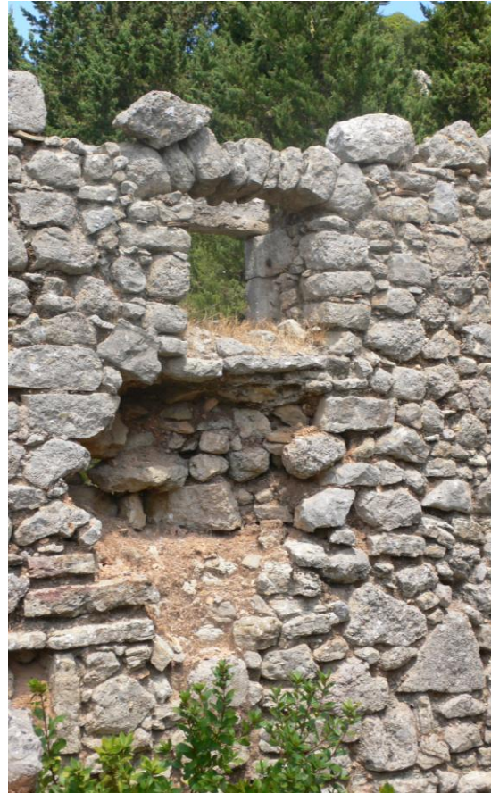
Εικόνα 115 - Κατάρρευση της εσωτερικής παρειάς της τοιχοποιίας
