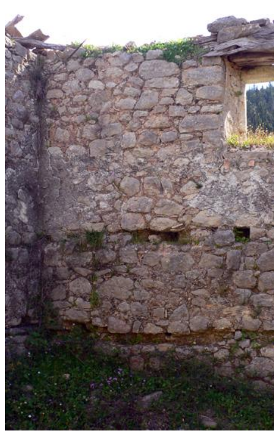
Εικόνα 100 - Υπολείμματα επιχρίσματος στο εσωτερικό του κτηρίου
