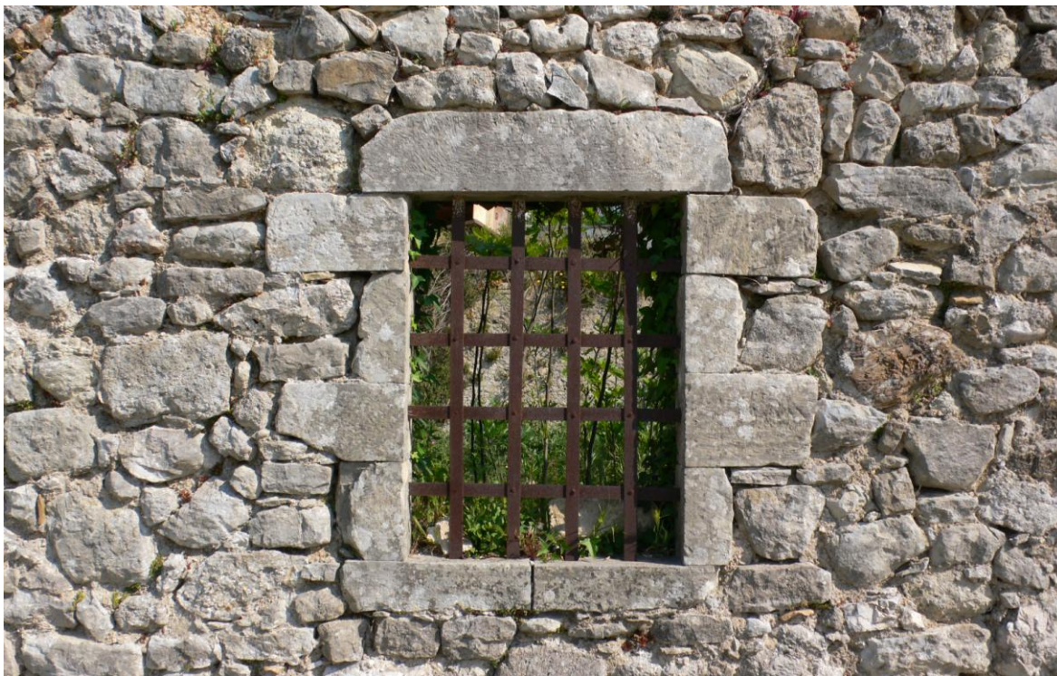
Εικόνα 26 - Καλολαξευμένοι λίθοι ανοιγμάτων σε κατεστραμμένο κτήριο στους Σφακιώτες
