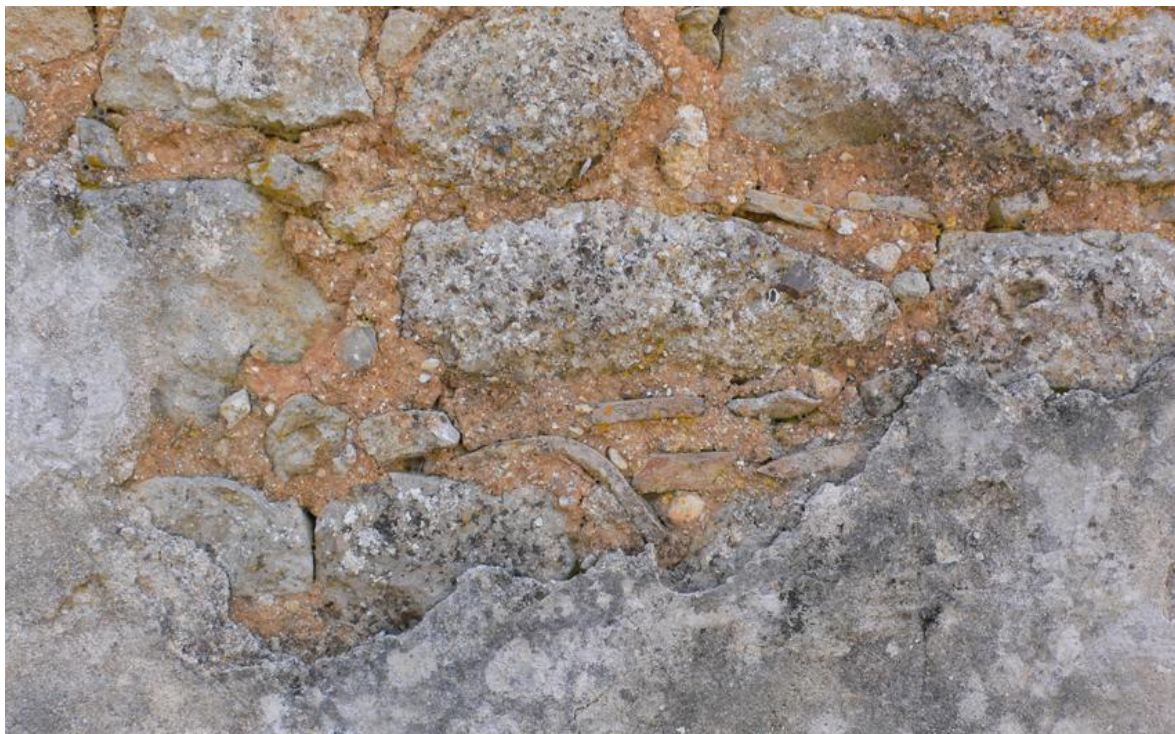
Εικόνα 194 - Αποκόλληση εξωτερικού επιχρίσματος με αποκάλυψη της υποκείμενης λιθοδομής
