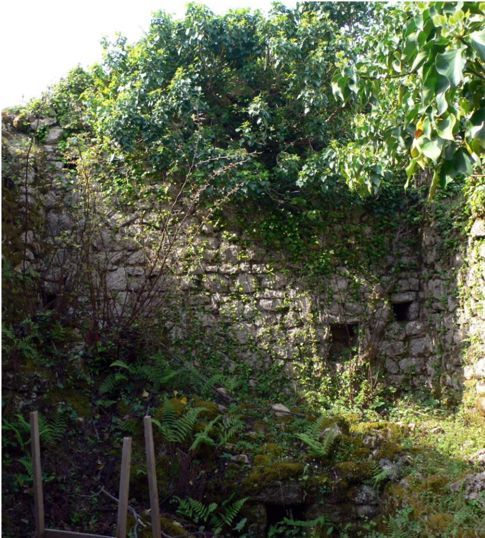
Εικόνα 143 - άποψη του κτηρίου Α κατειλημμένο από την βλάστηση
