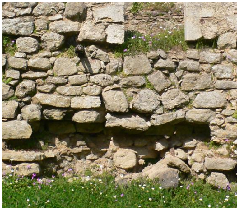
Εικόνα 102 - Τοπική αποκόλληση εξωτερικής παρειάς ανατολικής όψης
