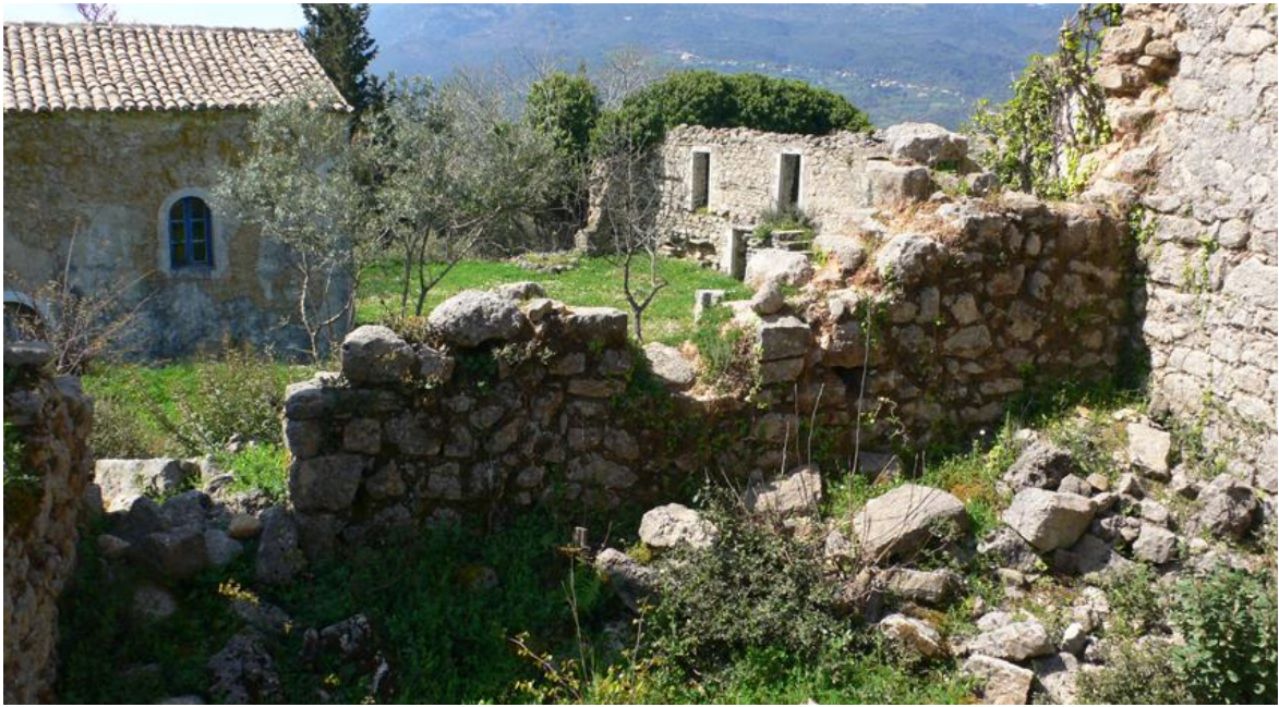
Εικόνα 190 - Εσωτερική άποψη του κατεστραμμένου τοίχου
