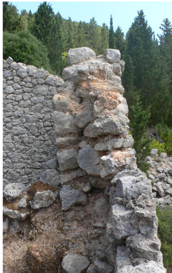
Εικόνα 192 - «Φούσκωμα» τοίχου και απόκλιση από την κατακόρυφο
