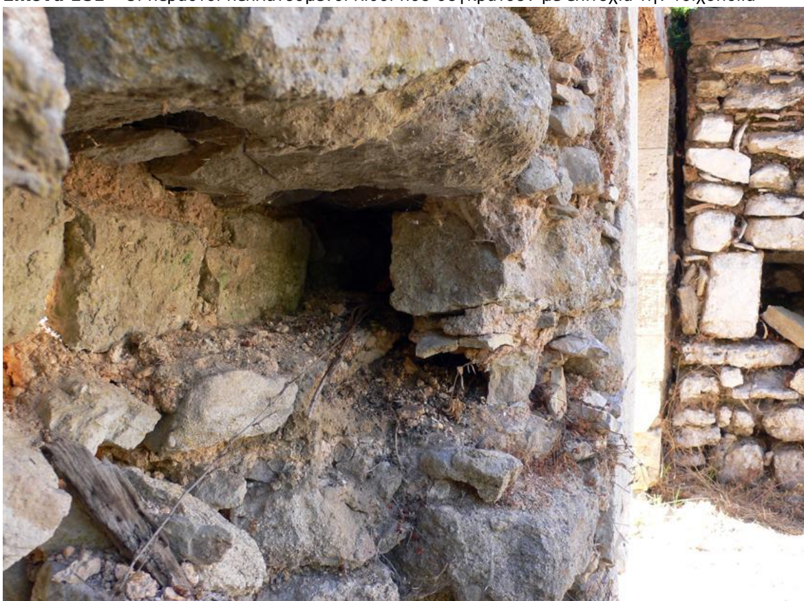
Εικόνα 182 - Αποκάλυψη της εσωτερικής στην τοιχοποιία ξυλοδεσιάς λόγω της τοπικής κατάρρευσης
