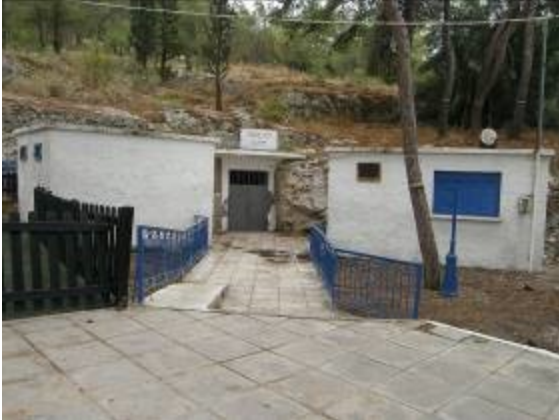
Οι δύο νέοι κτιριακοί όγκοι αποκρύπτουν την είσοδο του σπηλαίου και αλλοιώνουν το βράχο.
