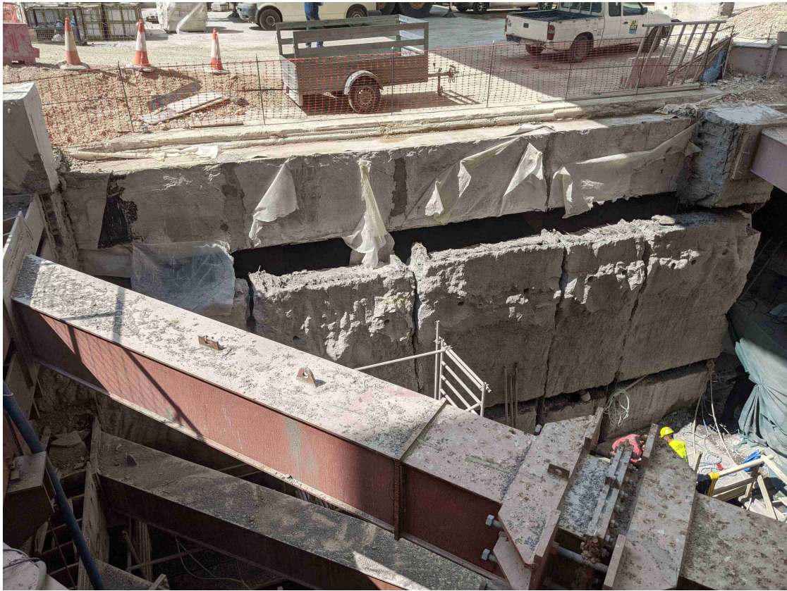
Εικόνα 3.1: Όψη των πανέλων των διαφραγματικών τοίχων κατά τη διαδικασία καθαίρεσής τους για την κατασκευή της πρόσβασης Ι
