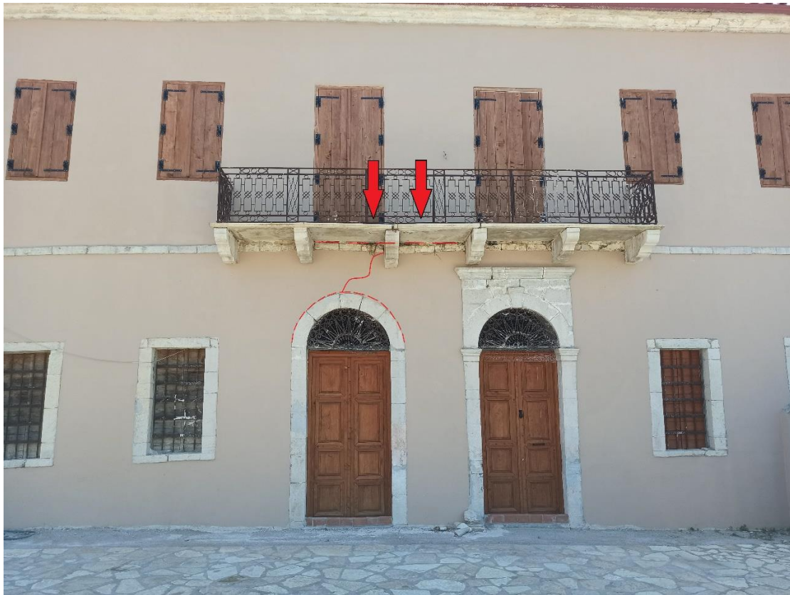
Εικόνα 51. Ζημιές σε μπαλκόνι παλαιού κτηρίου λόγω διαφορετικών καθιζήσεων (Μ)
