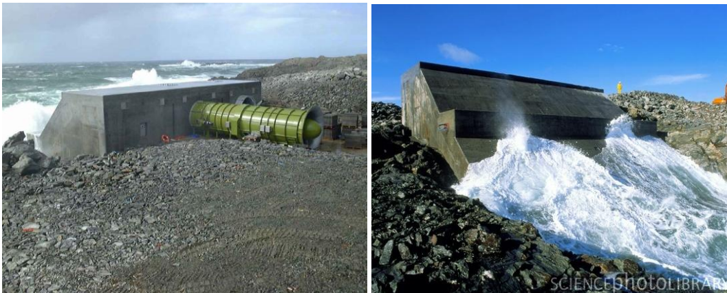
Εικόνα 3.3.3.: Εγκατάσταση παραγωγής ηλεκτρικής ενέργειας LIMPET 500 στο νησί του Islay της Σκωτίας.
