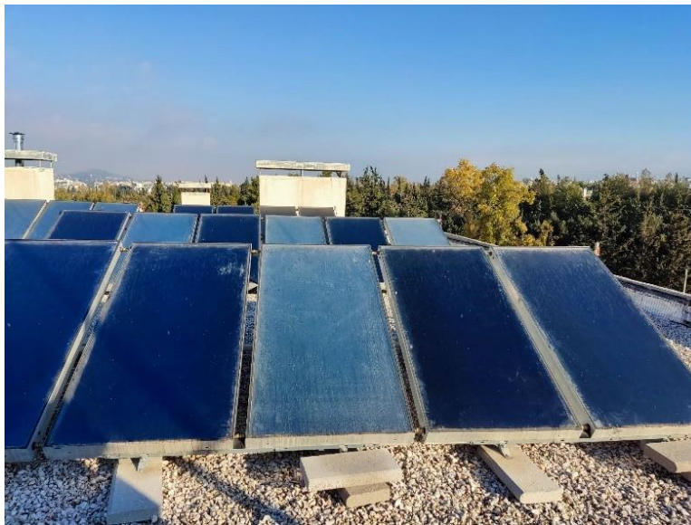
Εικόνα 2: Διάταξη ηλιακών συλλεκτών στην οροφή του Κτιρίου Ο (πρόοψη)
