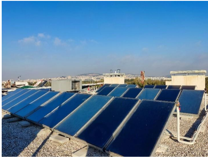
Εικόνα 1: Διάταξη ηλιακών συλλεκτών στην οροφή του Κτιρίου Ο (πλάγια όψη)
