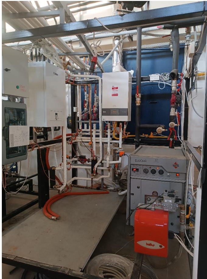
Εικόνα 6: Σύστημα καυστήρα φυσικού αερίου
