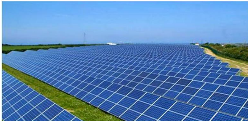
Εικόνα 2. 3. Συστοιχίες φωτοβολταϊκού πάρκου
