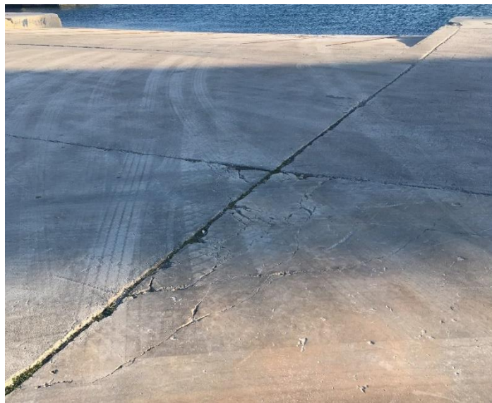
Εικόνα 23 - Παράδειγμα εντοπισμού ρωγμών από την οπτική επισκόπηση (λήψη φωτογραφίας κατά την επιτόπια επιθεώρηση της ομάδας του Εργαστηρίου Λιμενικών Έργων, Φεβρουάριος, 2020)
