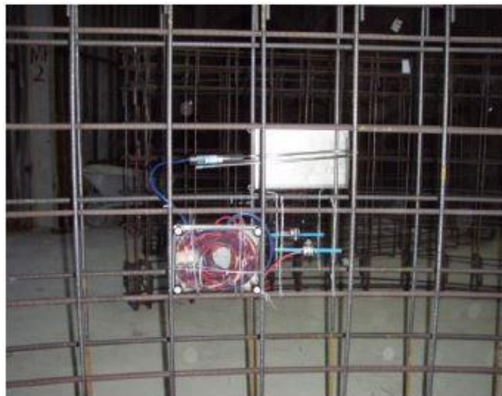
Εικόνα 3-24. Κυψέλη πίεσης εγκατεστημένη σε κλωβό τελικής επένδυσης σήραγγας (Μπίκος, Χ. (2019). Μέθοδοι ενόργανης παρακολούθησης της κατασκευής υπόγειου αστικού, σιδηροδρομικού δικτύου (METPO).
