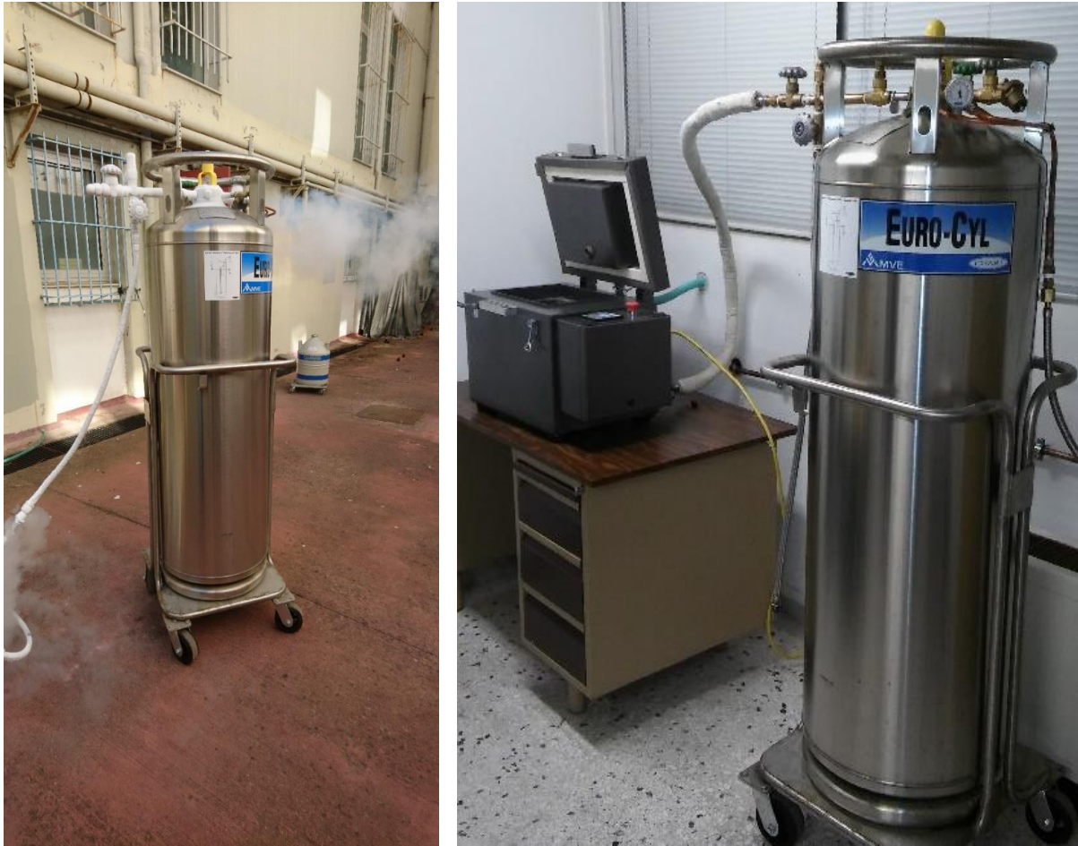
Εικόνα 64: Δεξαμενή αζώτου κατά το γέμισμα και μετά τη σύνδεση με τον κρυογενικό θάλαμο
