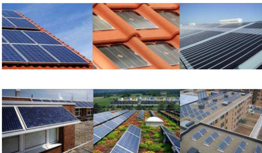
Εικόνα 12: Εγκαταστάσεις φωτοβολταϊκών συστημάτων
