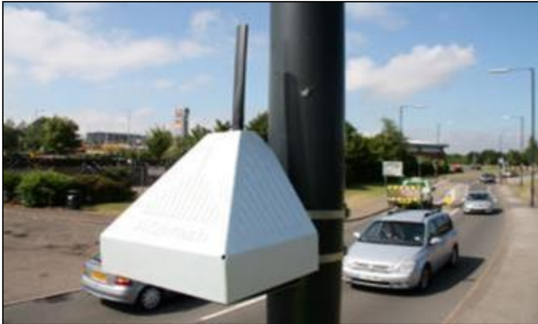
Εικόνα 6.4. Εγκατεστημένος πολυαισθητήρας παράλληλα με το δίκτυο ηλεκτροφωτισμού Πηγή: arta.gr
