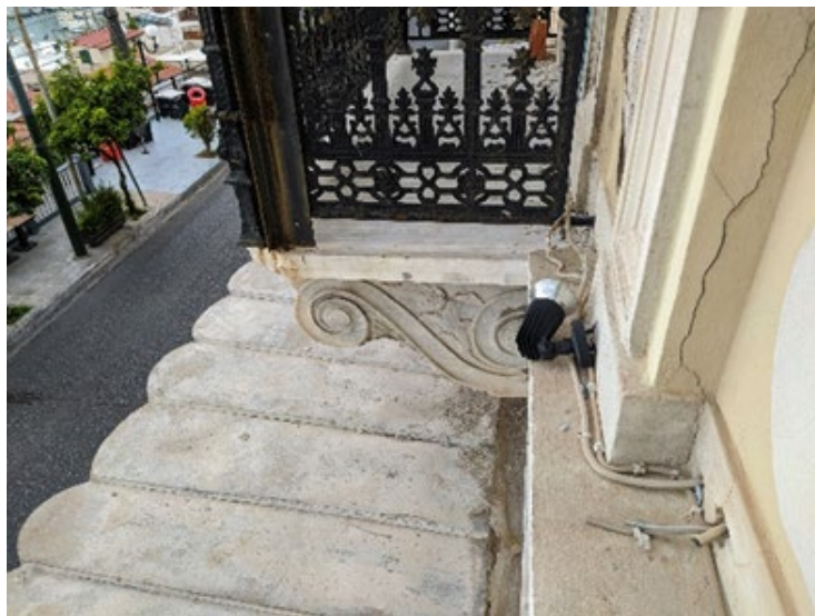
Εικόνα 3.5.5 Ρηγματώσες στους λαμπάδες των κουφωμάτων
