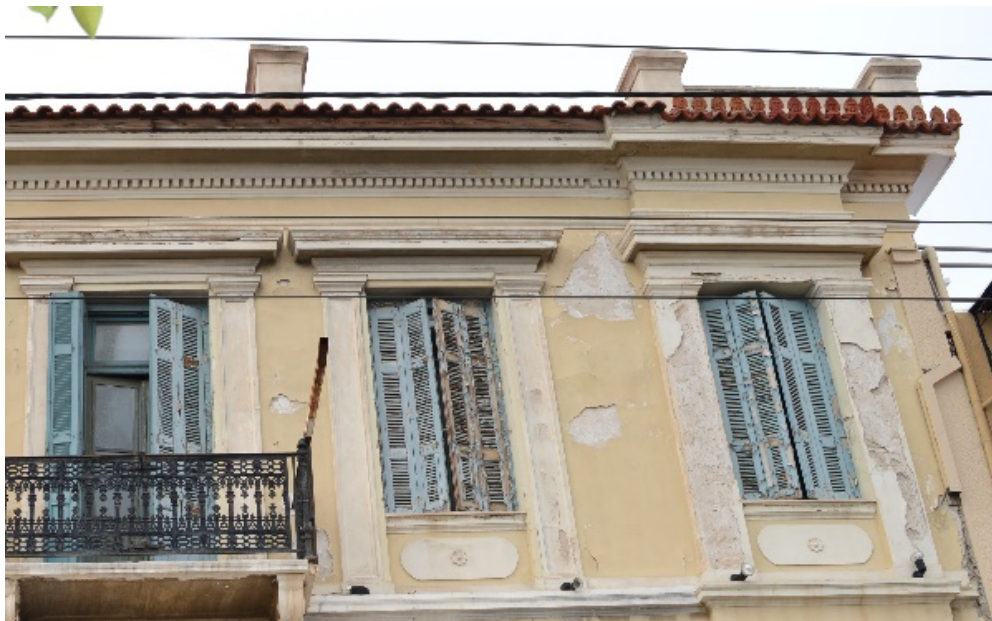
Εικόνα 3.5.2 βλάβες στο επίχρισμα
