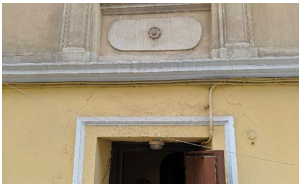
Εικόνα 3.5.3 Κατακόρυφες ρωγμές σε υπέρθυρα
