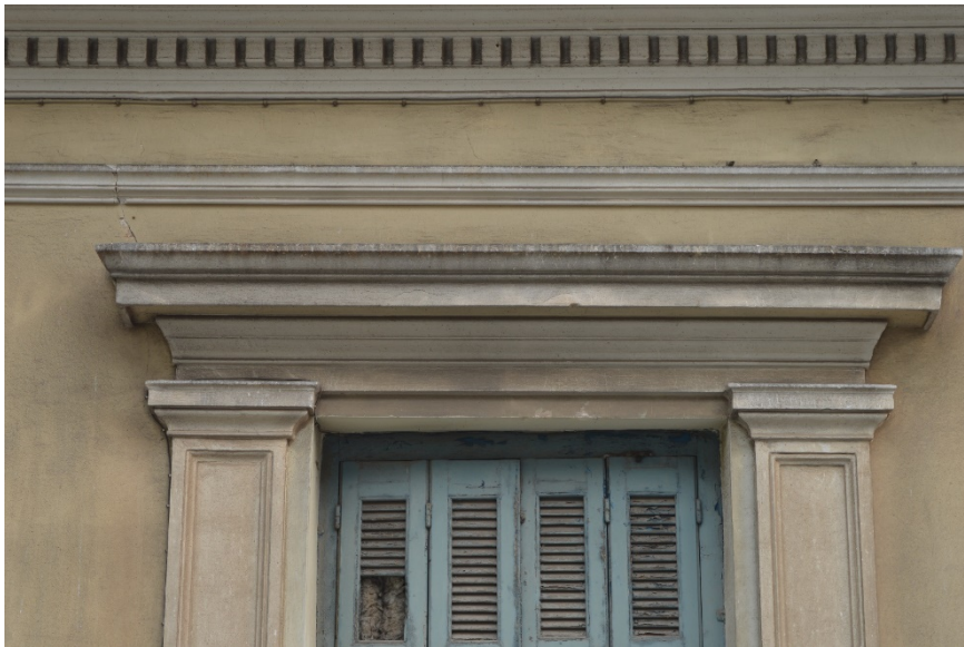
Εικόνα 3.5.4 Κατακόρυφες ρωγμές σε υπέρθυρα
