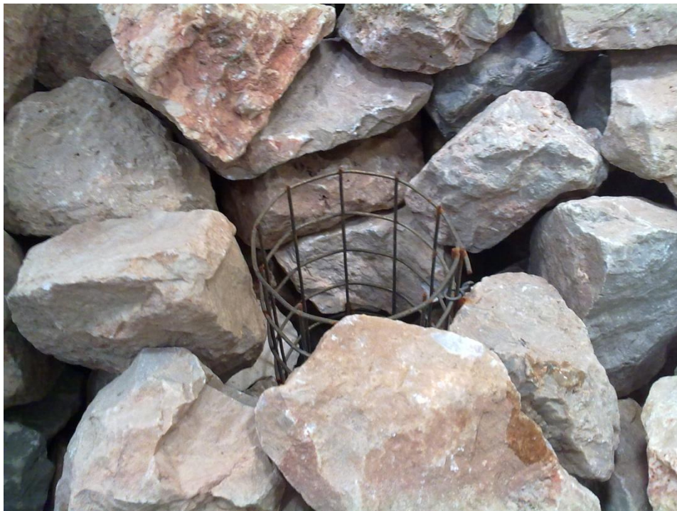
Σχήμα Β.9 – Συρμάτινο πλαίσιο για την ασφάλεια του μολίσκου κατά τη διάρκεια των μετρήσεων στο εσωτερικό του κυματοθραύστη
