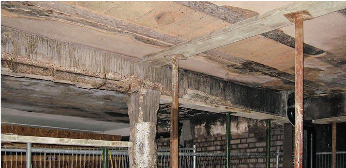
Εικόνα 13: Εμφανείς βλάβες σε δομικά στοιχεία εξαιτίας πυρκαγιάς
