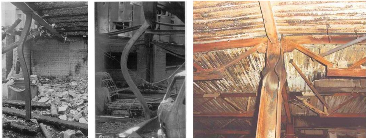
Εικόνα 31: Σημάδια αστοχίας υποστυλωμάτων
