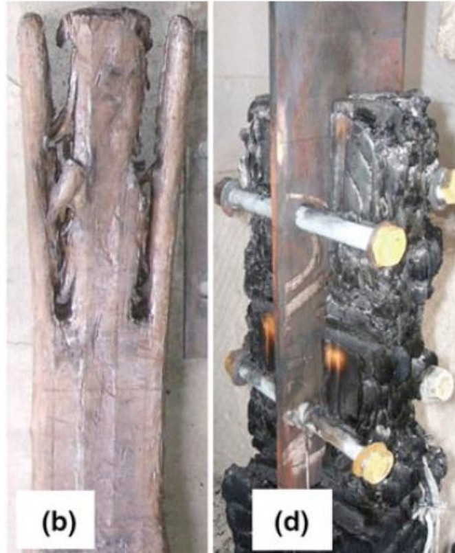
Εικόνα 35: Χαρακτηριστική αστοχία μεταλλικού συνδέσμου δομικής ξυλείας
