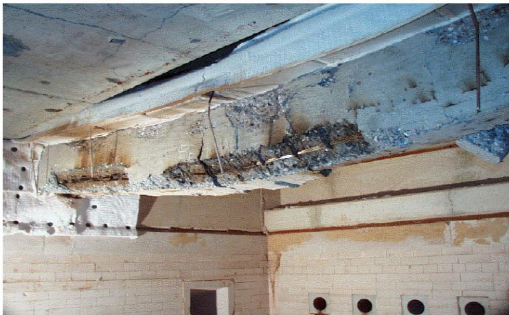
Εικόνα 14: Βλάβη σε δοκό με αποκάλυψη οπλισμού εντός πειραματικής διάταξης
