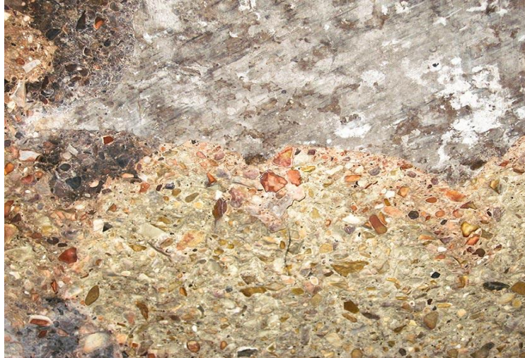
Εικόνα 16: Αποχρωματισμός σκυροδέματος εξαιτίας πυρκαγιάς
