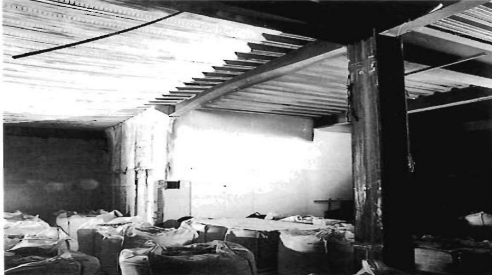
Εικόνα 28: Αστοχία δοκού οροφής σε πλευρική στρέψη και κάμψη
